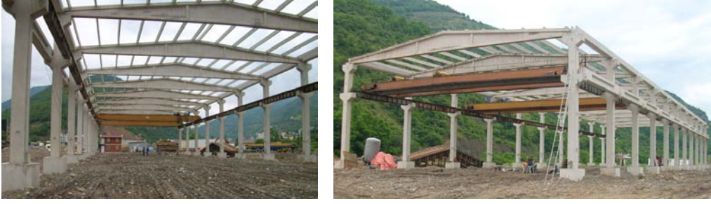
Şekil 2.13. Doğu Karadeniz Prefabrik Üretim Tesisi'ne ait görüntüler
