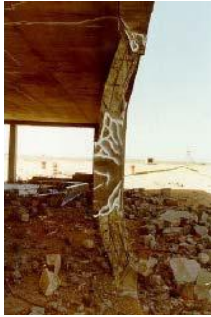
Şekil 1.30. Patlama ile hasar gören bir betonarme kenar kolon
