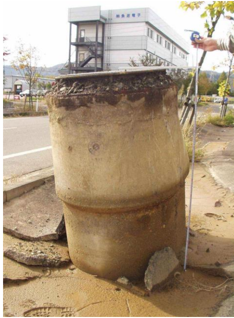
Şekil 32. Sıvılaşma etkisiyle zemin yüzeyine yükselen bir kanalizasyon muayene bacası (Tanaka vd., 2011).
