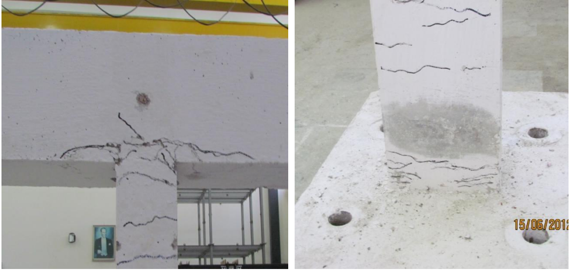
Şekil 90. Kolon-kiriş ve kolon-temel birleşim bölgelerinde oluşan mafsallaşmalar.
