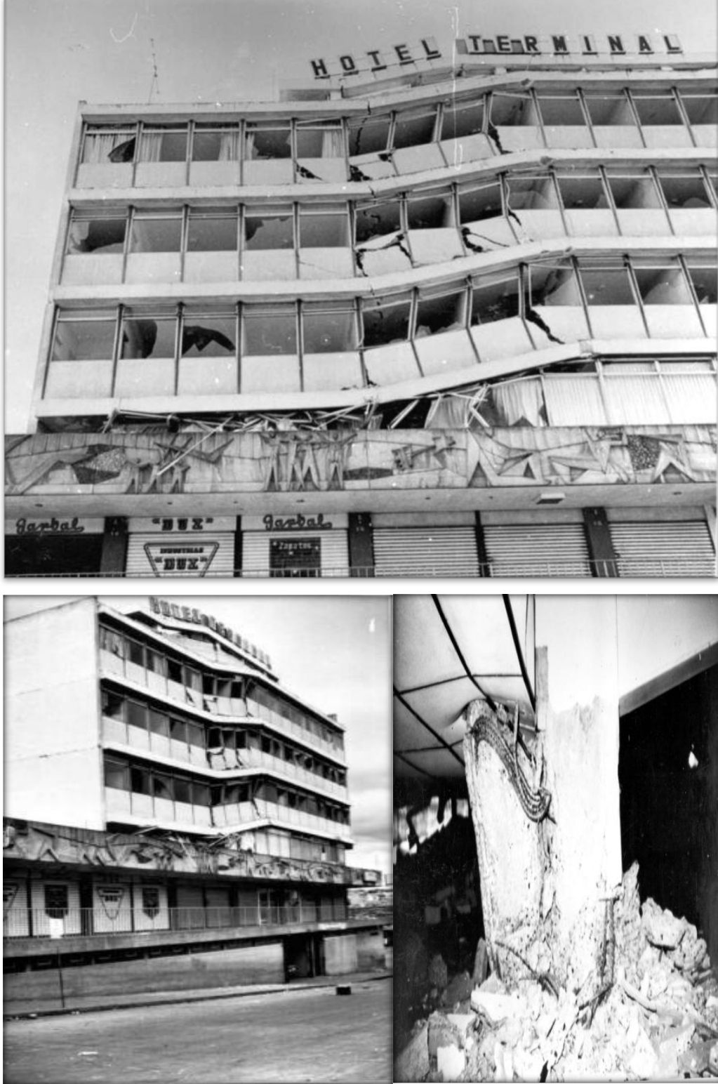
Şekil 15. 1976 Guatemala depreminde burulma hasarı görmüş bir otel binası.
