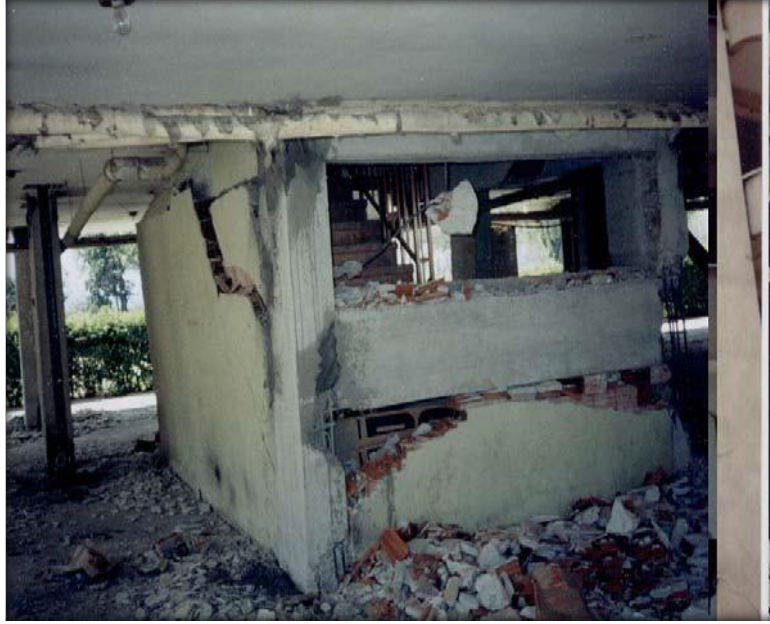
Şekil 32. Merdiven ara sahanlığında oluşan kısa kolon hasarları [27].
