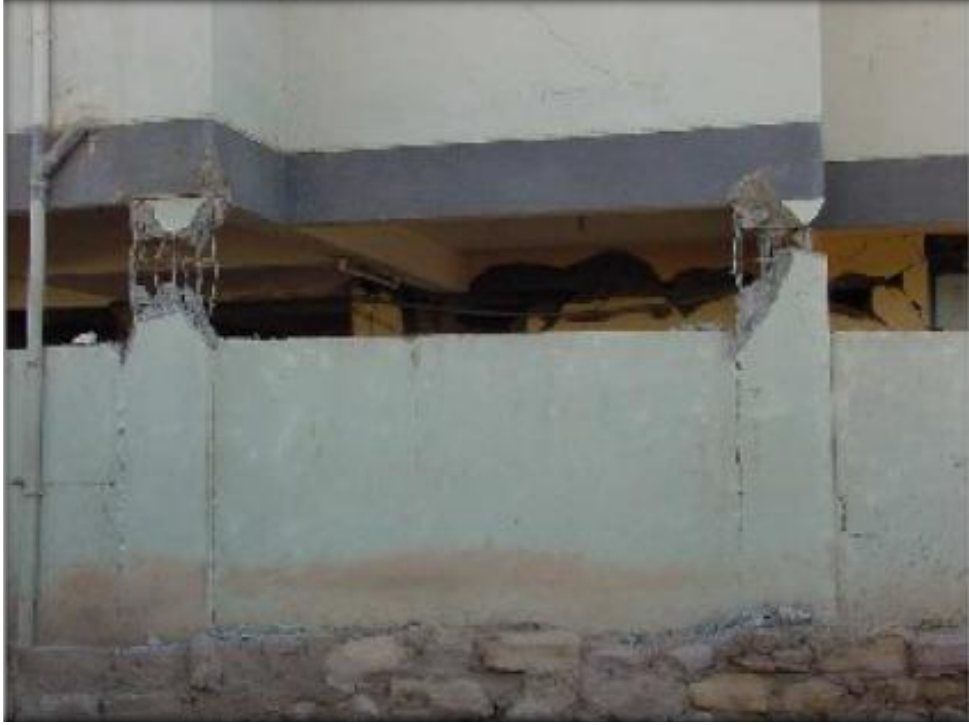
Şekil 35. Bodrum kat dış perde duvarında oluşan kısa kolon hasarları [17].
