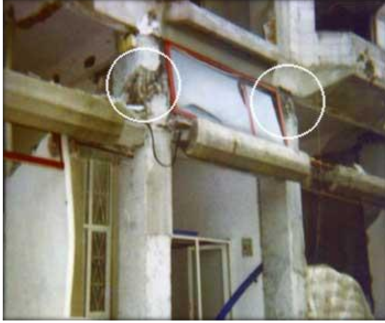
Şekil 31. Asma kat nedeni ile oluşan kısa kolon hasarları [26].
