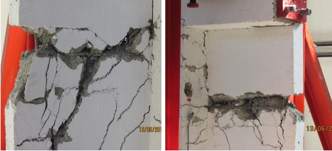
Şekil 106. Nihai durumda mevcut perdede meydana gelen hasarlar.
