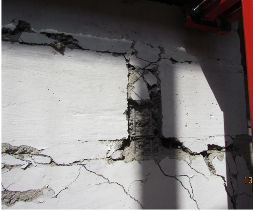
Şekil 105. Maksimum yükün % 85' ine gelindiğinde (göçme anı) kolonda meydana gelen hasarlar.
