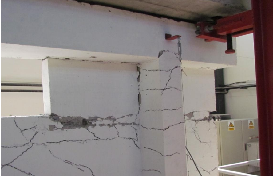
Şekil 107. Kolon ön yüzünde meydana gelen eğilme çatlakları.
