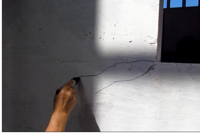
Şekil 103. Perde ile kanat duvar birleşiminde meydana gelen ilk çatlak.
