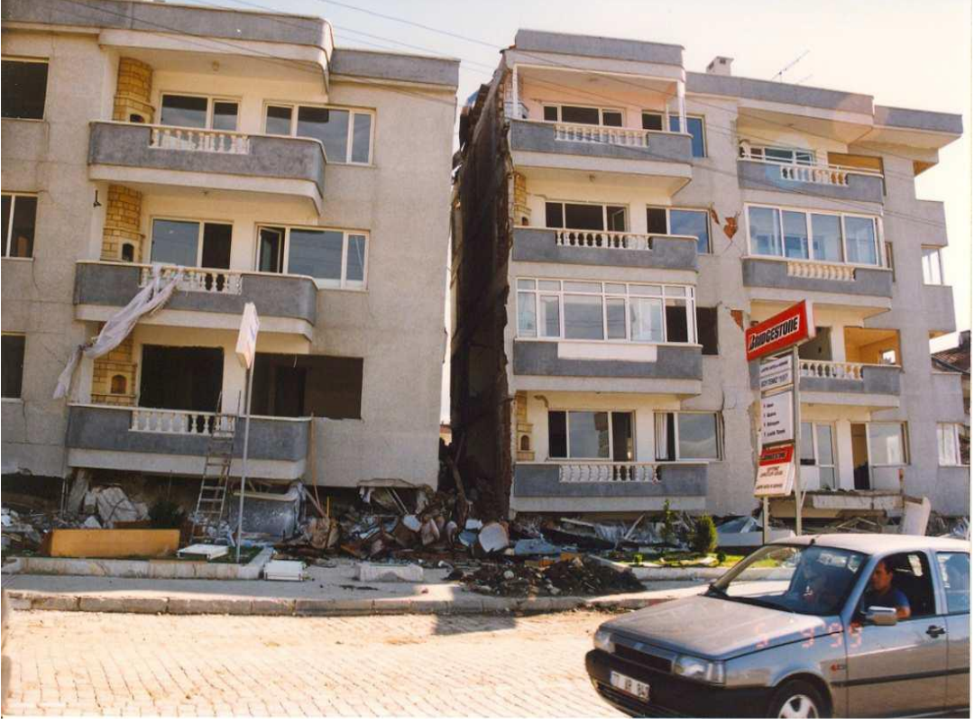
Şekil 23. Binaların giriş katlarında yumuşak kat hasarları [17].
