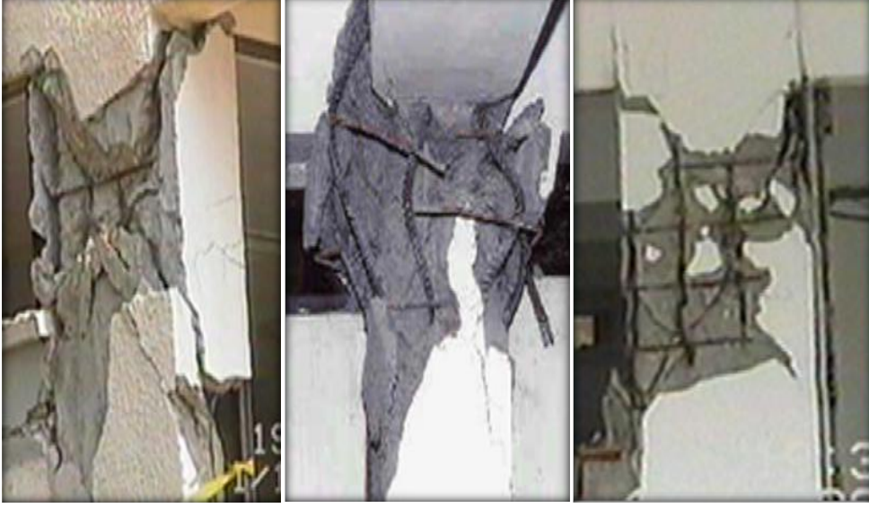
Şekil 36. Bant pencere nedeniyle oluşan kısa kolon hasarları.1999 İzmit depremi [25].
