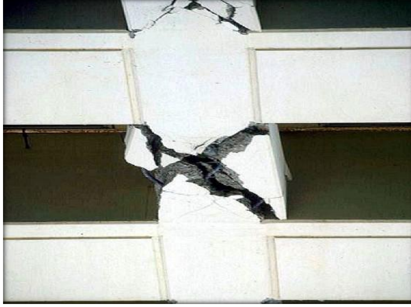
Şekil 34. Parapet duvarlar nedeni ile oluşan kısa kolon hasarı [17].
