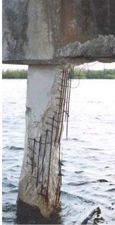
Şekil 1.7. Betonarme yapılarda ilerlemiş donatı korozyonu [73].
