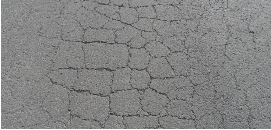
Şekil 1.7. Timsah sırtı çatlak
