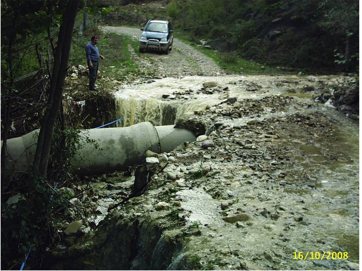
Şekil 1.14. Sinop Ayancık Köy yolunda tıkanmış bir beton büz.
