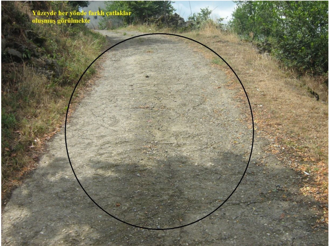
Şekil 2.2. Bulak Köyü, Soğuksu Mevki. Yol üzeri çatlaklar.
