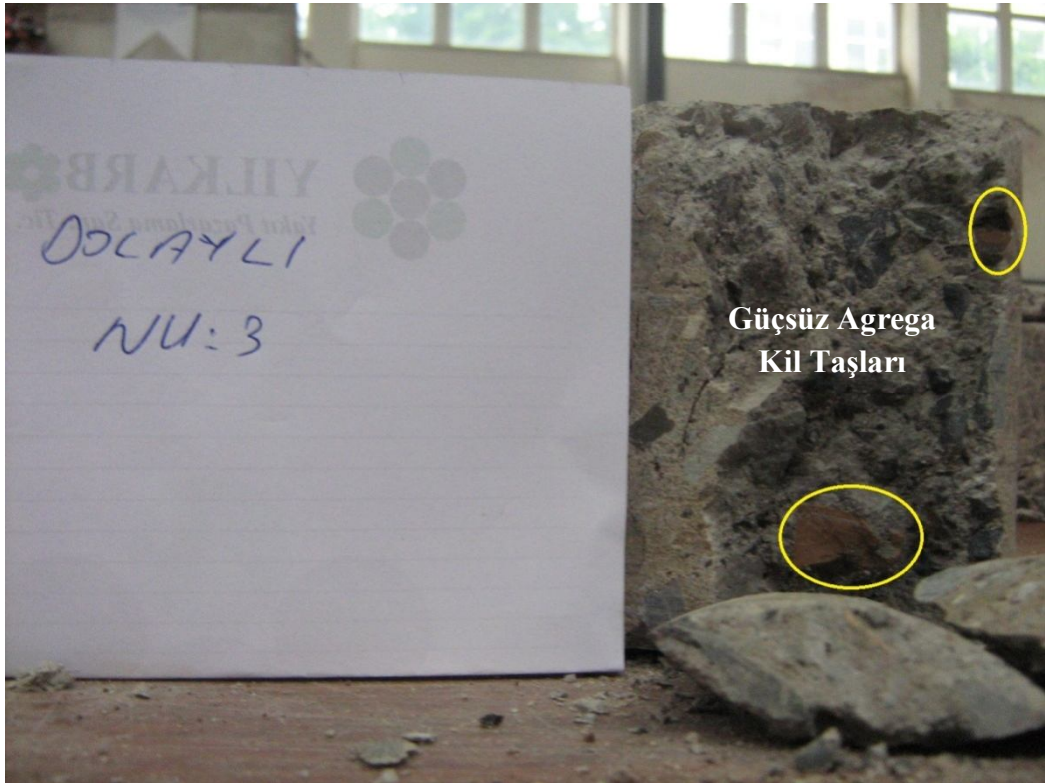
Şekil 3.10. Dolaylı köy içi 3 nolu numunede kalın agregaların elle kırılabilen zayıf agregalar olduğu görülmüştür.
