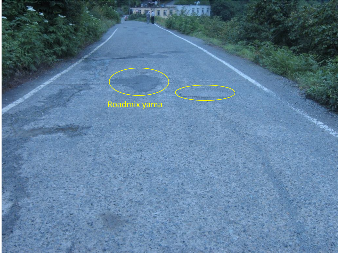
Şekil 2.6. Dolaylı Köy içi beton yolu. Bazı kısımlarda yama malzemesi görülmüştür.
