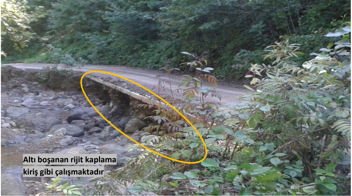
Şekil 1.6. Trabzon Araklı İlçesi Bereket köyü Şifalı su tesislerine giden yol, 20 cm beton kaplama olan yolda sel sonrası oluşan çökmeler kaplamayı bozmamıştır.
