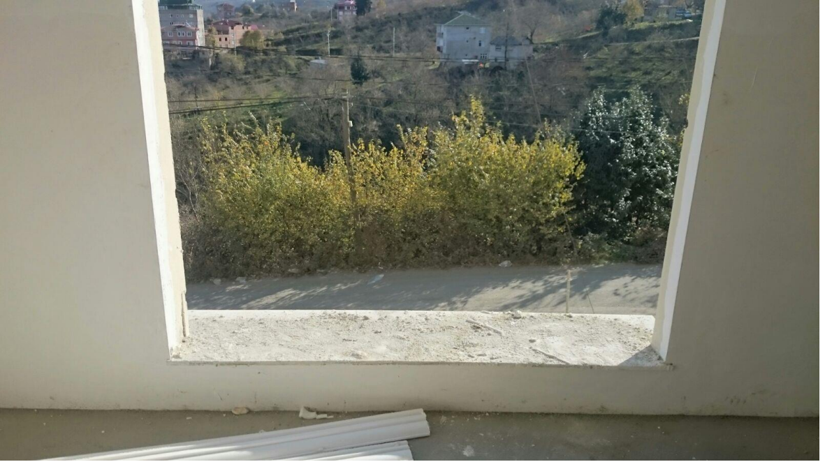
Şekil 49. Anket yapılan bir inşaat şantiyesinde, binanın pencere boşluklarının kapatılmadığı görülmektedir.
