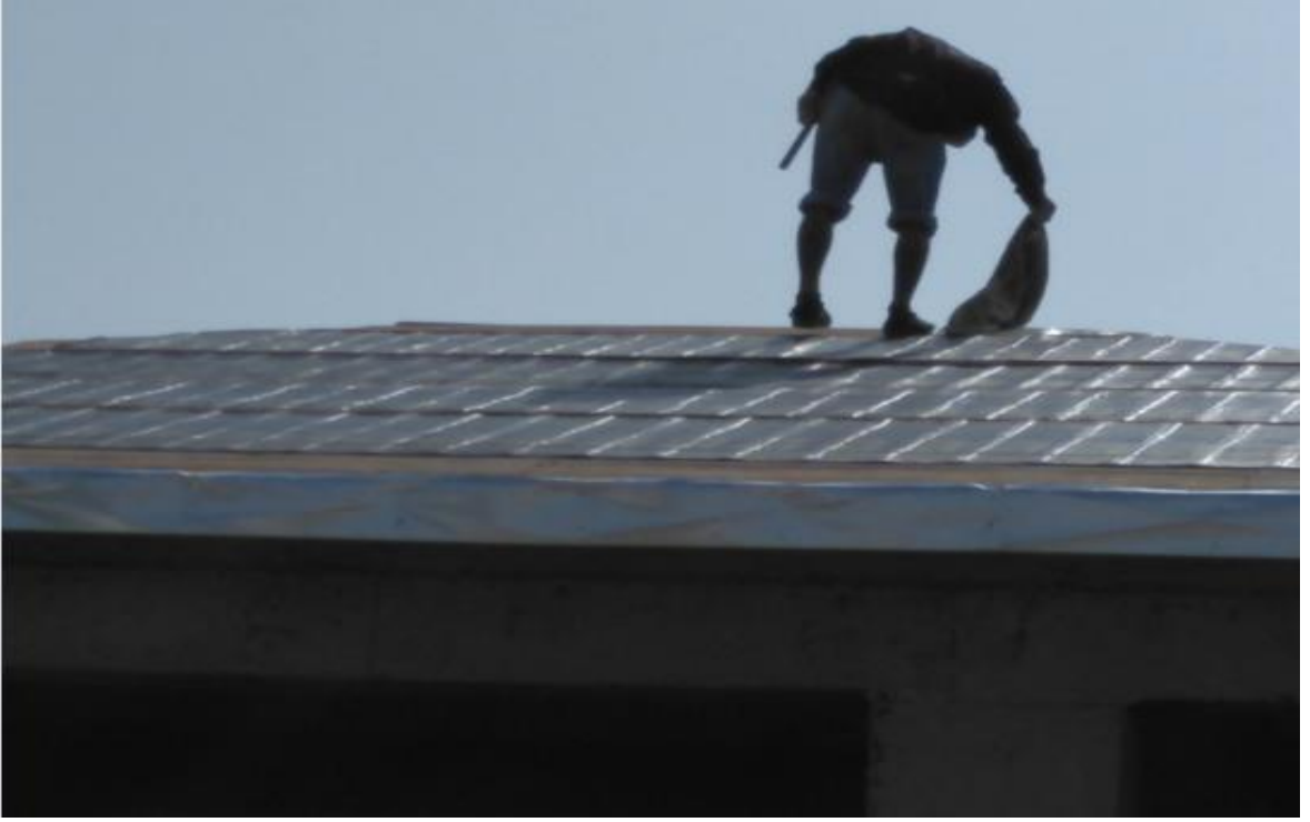
Şekil 52. Anket yapılan bir inşaat şantiyesinde, çatıda işçinin emniyet kemeri olmadan çalıştığı görülmektedir.
