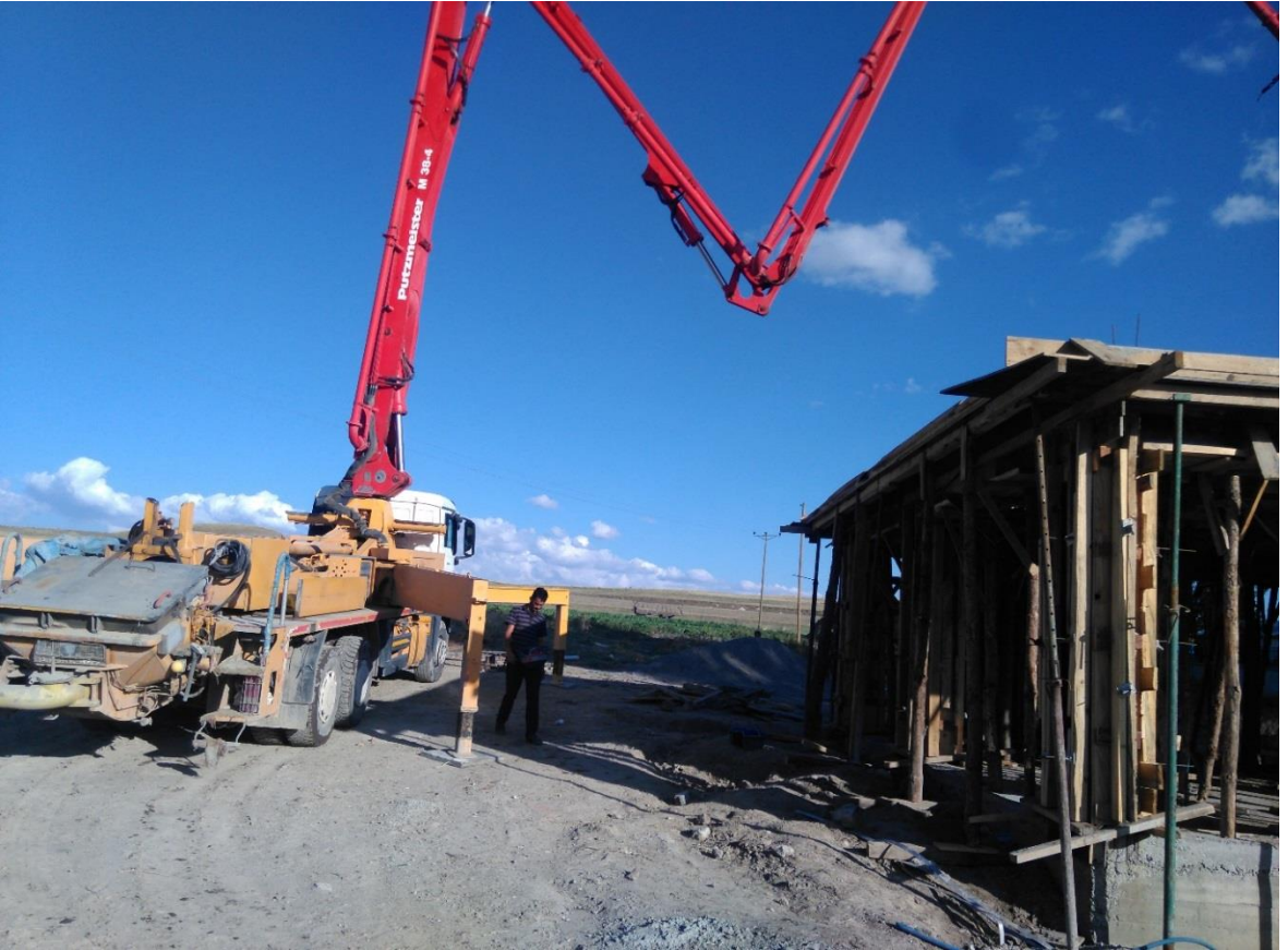
Şekil 51. Anket yapılan bir inşaat şantiyesinde, beton dökümü sırasında pompa altında çalışanın bulunduğu görülmektedir.
