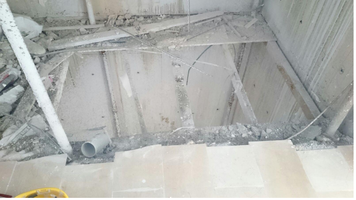
Şekil 48. Anket yapılan bir inşaat şantiyesinde, bina içinde açılan boşlukların kapatılmadığı, bunun yanında etrafının engellerle çevrilmediği görülmektedir
