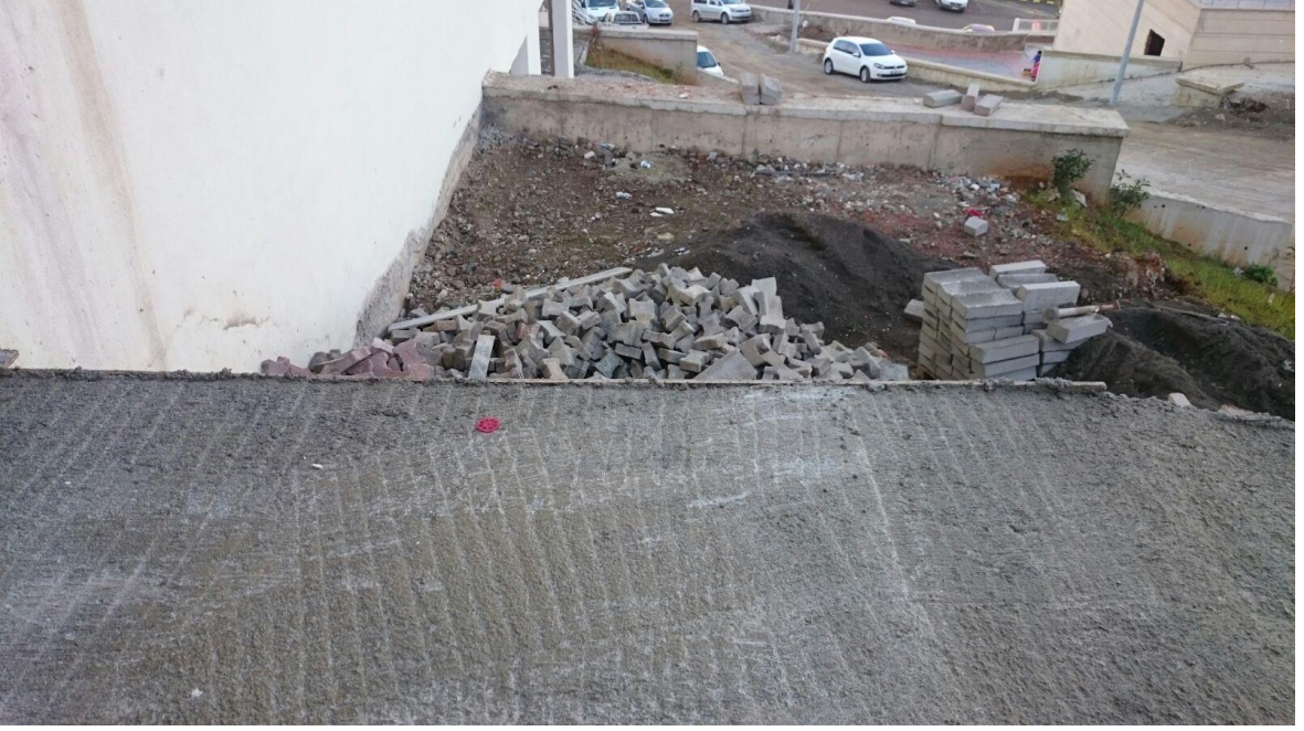
Şekil 50. Anket yapılan bir inşaat şantiyesinde, malzeme stokunun düzenli yapılmadığı görülmektedir.
