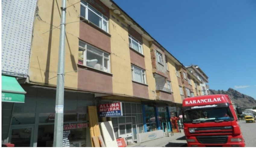
Şekil 12. Görünen yapı kalitesi kötü olan betonarme bina
