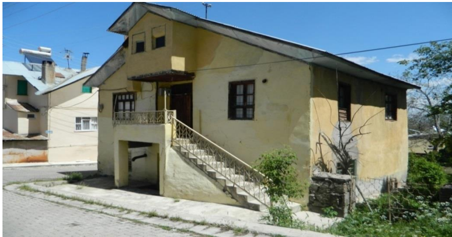
Şekil 21. Görünen kalitesi orta olan yığma bina
