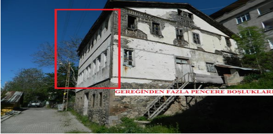
Şekil 23. Duvar boşluk oranı çok olan yığma bina
