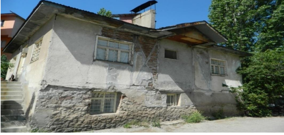
Şekil 22. Görünen kalitesi kötü olan yığma bina
