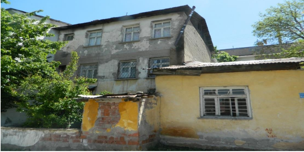
Şekil 30. Çarpışma etkisindeki yığma bina
