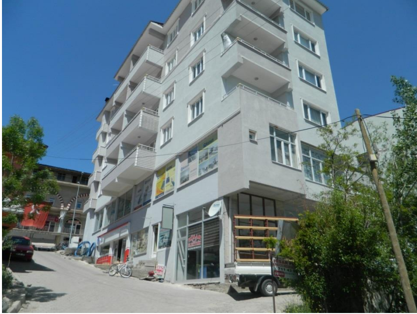
Şekil 14. Zemin yamacının kolon serbest boyunu kısaltması nedeniyle kısa kolonlu betonarme bina
