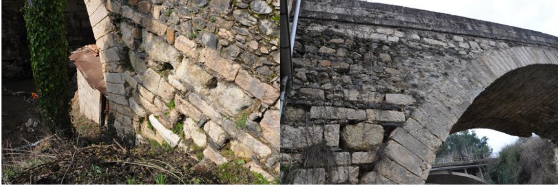
Şekil 2.6. Köprüde tempan duvar hasarlarına ait kopma, kırılma ve çatlama sorunları
