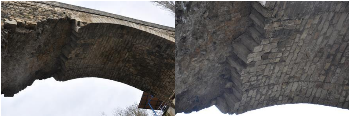
Şekil 2.5. Kemer bölgesine ait bazı ayrışma ve eleman kayıpları
