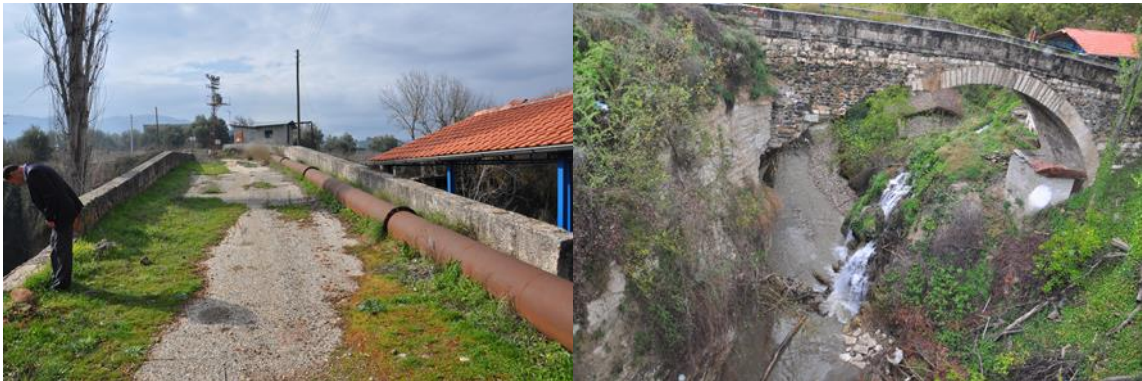
Şekil 2.7. Dandalaz Köprüsü'nde bitkilenme sorunlarına ait bazı görüntüler
