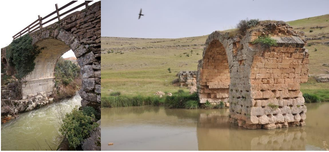
Şekil 1.11. Hasarlı köprü örnekleri (URL 9, 2015; URL 10, 2015)
