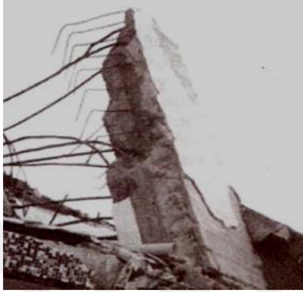
Şekil 1.4. Etriyeleeri açılmış bir betonarme kolon
