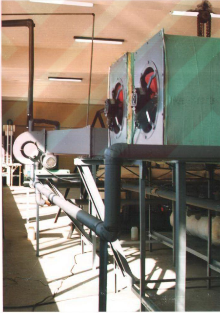
Şekil 3.9. Sistemdeki Hava Akışını Sağlayan Fanlar.
