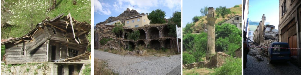
Şekil 1.14. Yıkılmış yapı örnekleri
