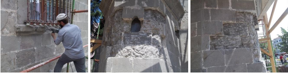
Şekil 2.211. Hacı Kasım Camii taş çürütmeleri
