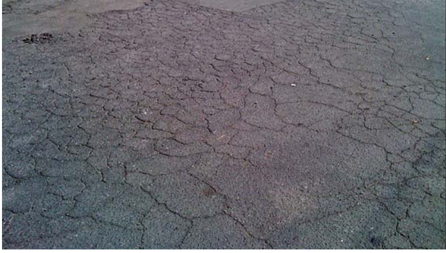
Şekil 25. Timsah sırtı çatlaklar [168].
