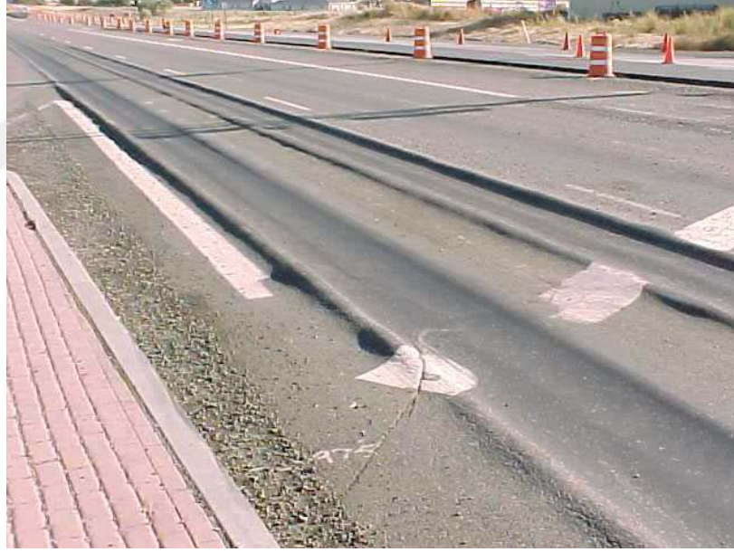
Şekil 19. Tekerlek izi oluşumu [168].
