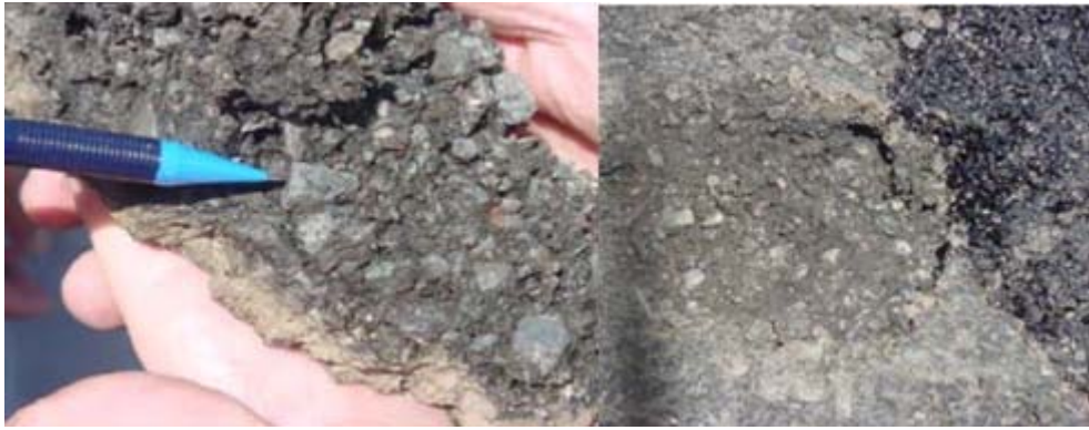
Şekil 24. Kaplamada soyulma oluşumu [175].
