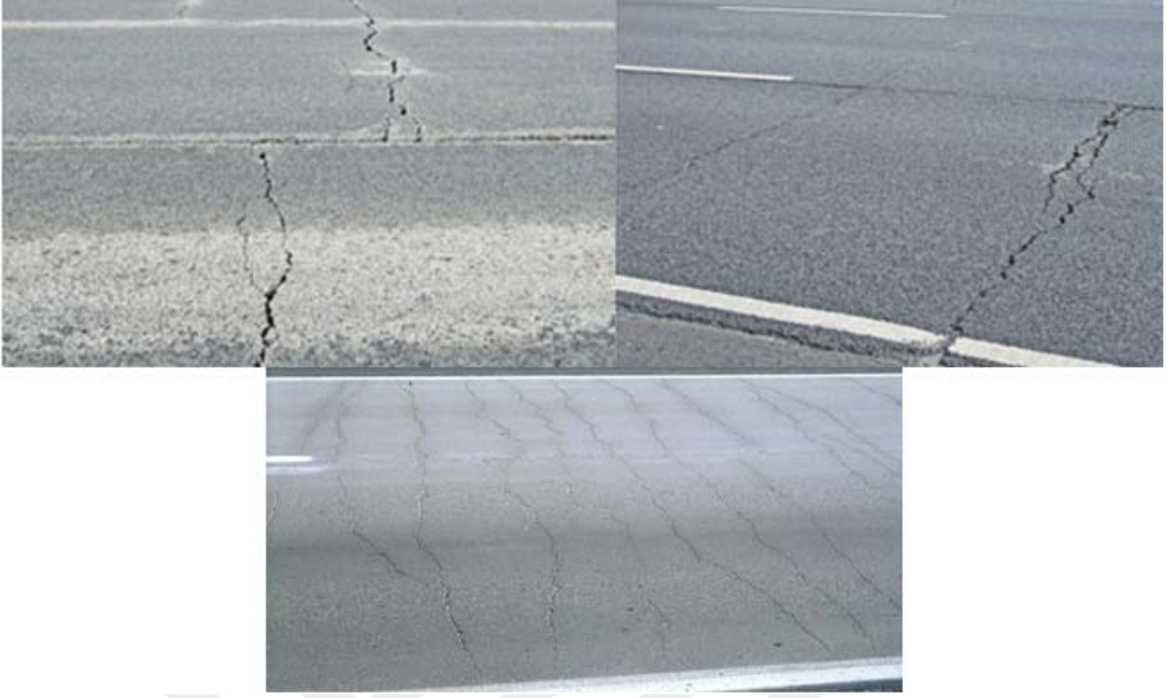
Şekil 26. Düşük ısı çatlakları [177, 178].
