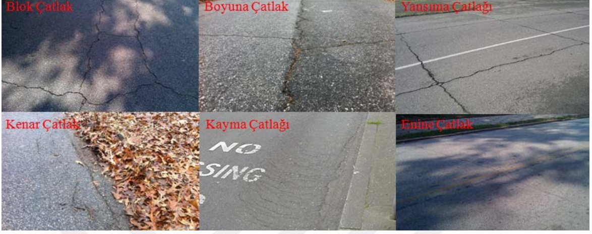
Şekil 27. Kaplamada oluşan çatlak tipleri [168].
