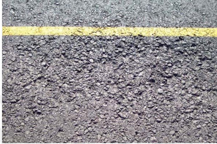
Şekil 22. Kaplamada ayrışma oluşumu [175].
