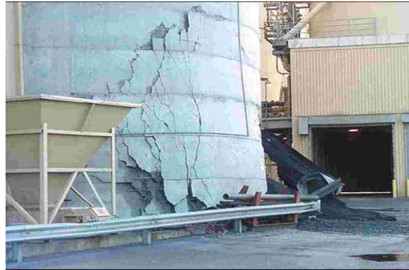
Şekil 1.23. MEA kömür silosunun dış hasarından bir görünüm (Kazas 2001)
