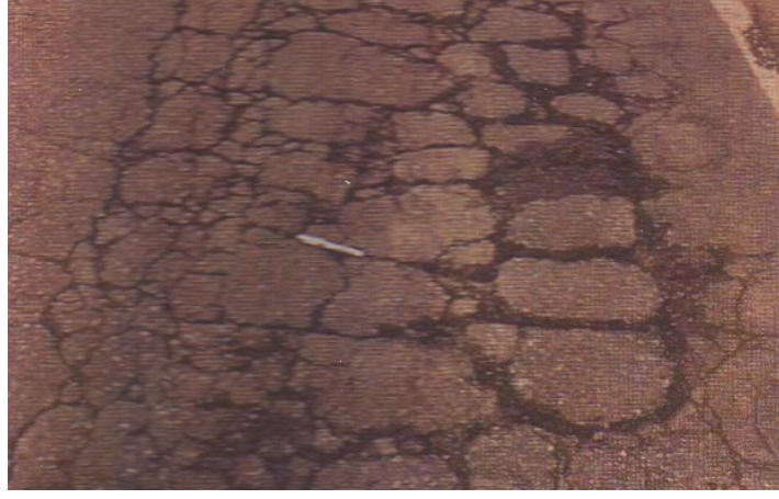
Şekil 24. Timsah sırtı çatlak
