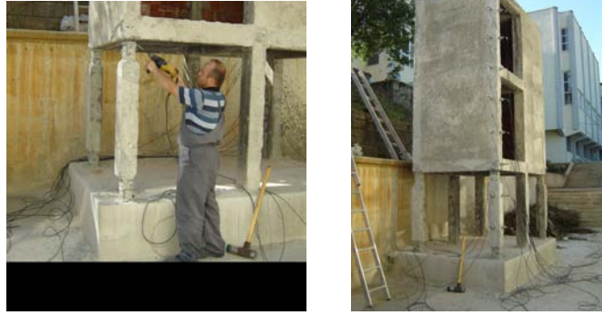
Şekil 2.88. Üç katlı betonarme bina modelde Hasar 7 durumu
