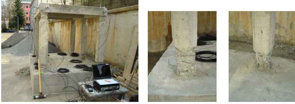
Şekil 2.42. Tek katlı betonarme modelde kolon alt uçlarında kabuk betonu hasar durumu
