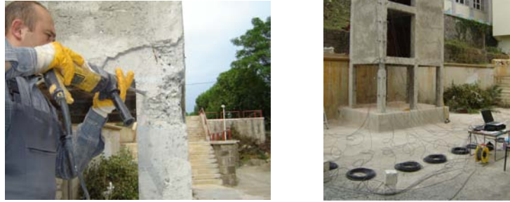
Şekil 2.82. Üç katlı betonarme bina modelde Hasar 5 durumu
