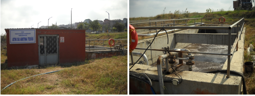
Şekil 7. Trabzon hava limanı paket atıksu arıtma tesisi görünümü
