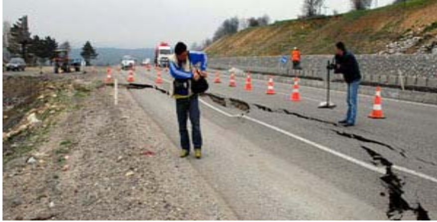
Şekil 3. D-100 karayolunun İstanbul-Ankara yönünde, Abant Kavşağı'na yaklaşık 1,5 kilometre uzaklıkta meydana gelen bir çökme (URL-3, 2008)
