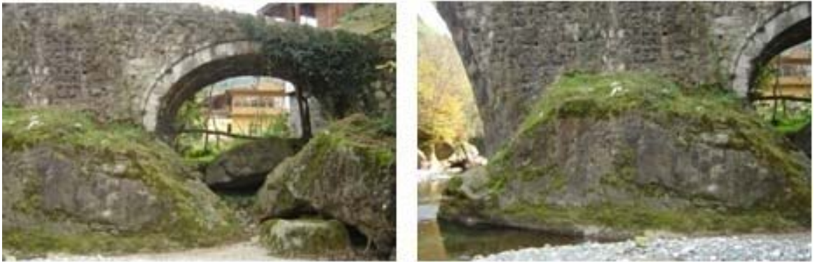
Şekil 3.6. Kemer ayaklarda ve yan duvarlarda zamanla oluşan mesnetleşmeler
