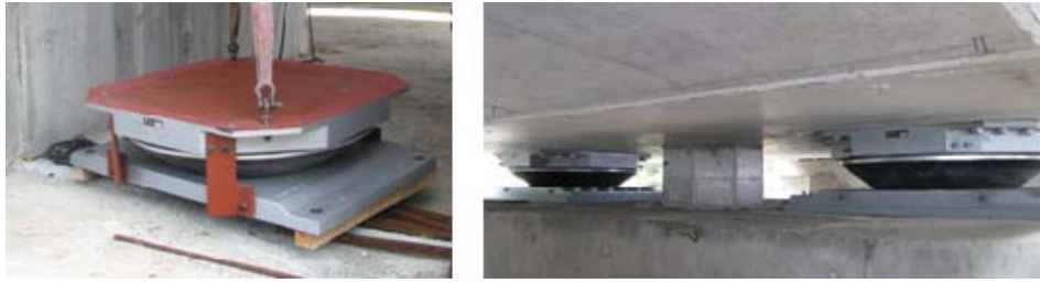
Şekil 2.81. Köprüde kullanılan sürtünmeli sarkaç izolatörlere ait bazı görünüşler
