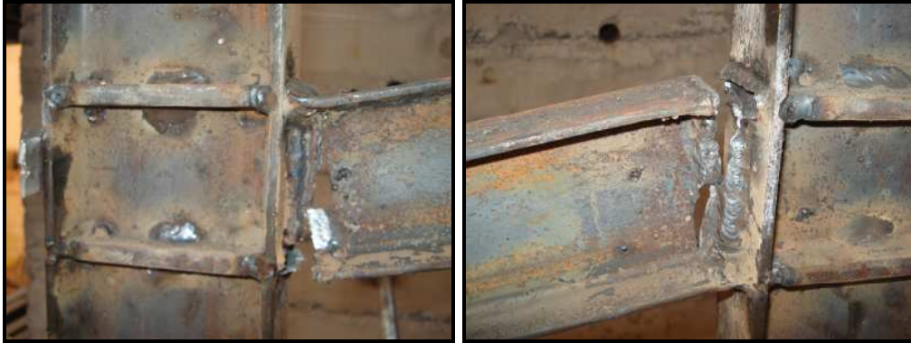
Şekil 79. N-1 Boş çerçeve deney numunesinde göçme durumunda oluşan hasarlar
