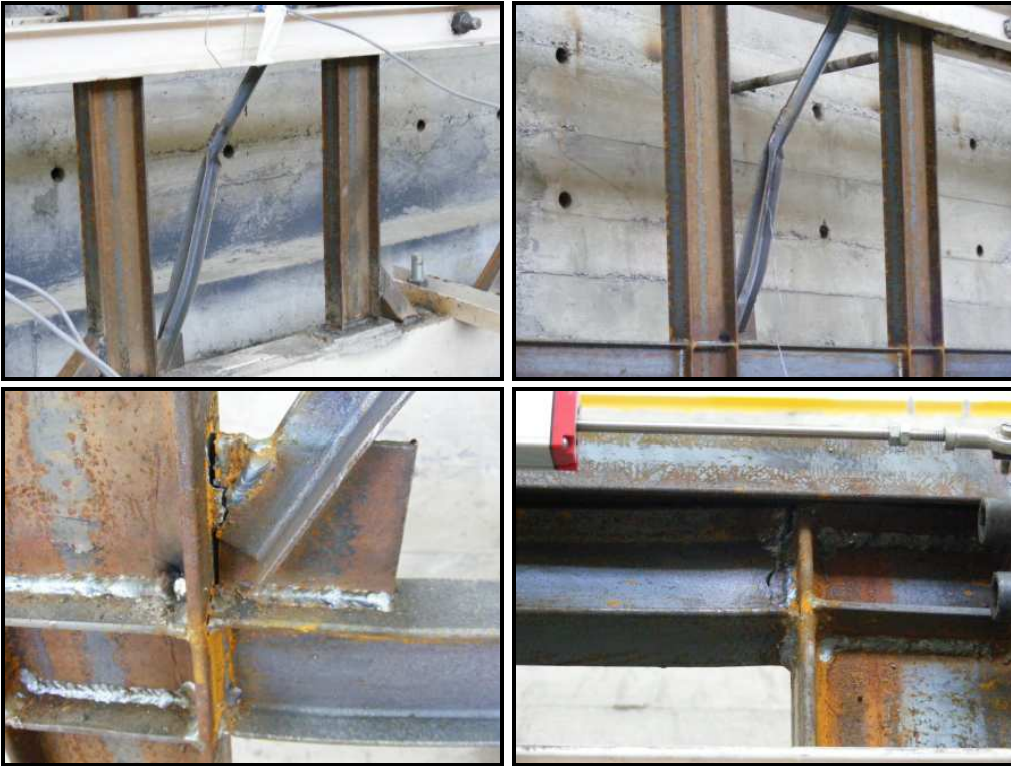
Şekil 114. N-7. Tek yönlü çelik köşegenli çerçevenin birleşim noktalarında oluşan hasarlar
