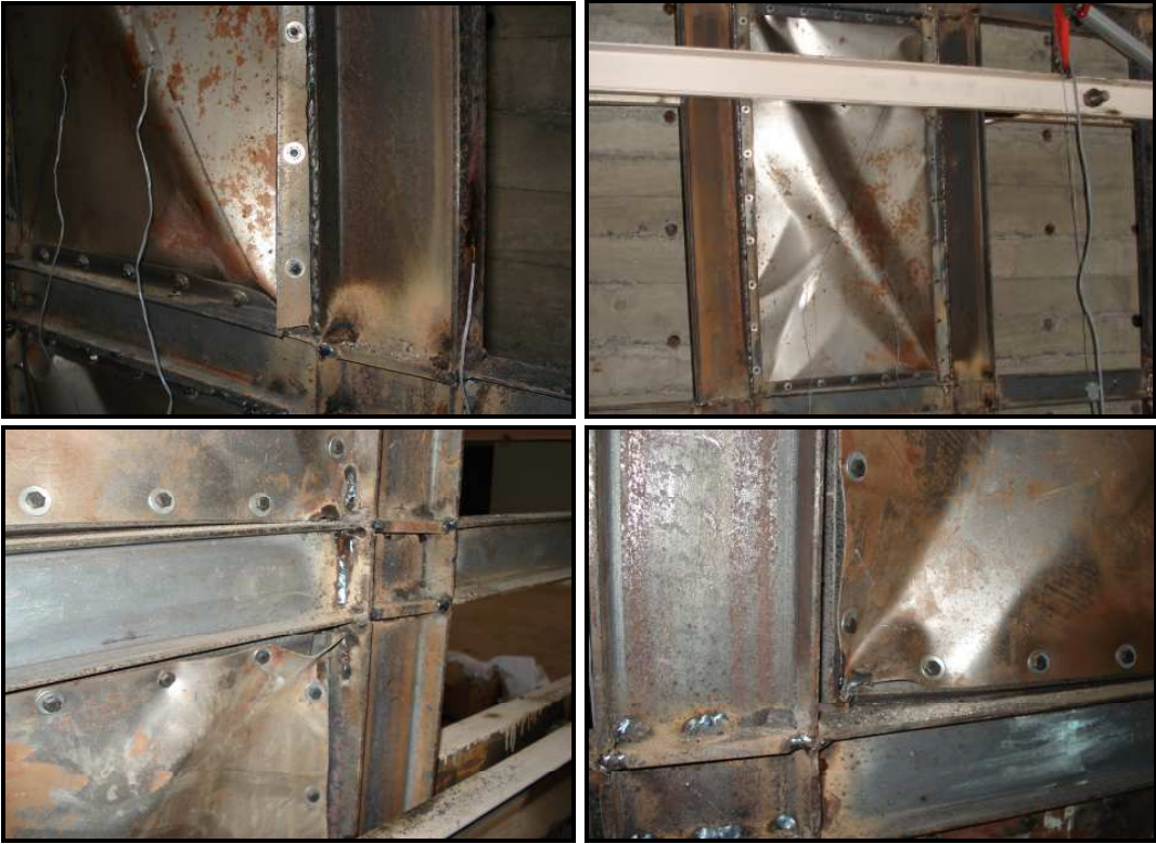
Şekil 102. N-5 Çelik levha perde duvarlı çerçevenin birleşim noktalarında oluşan hasarlar
