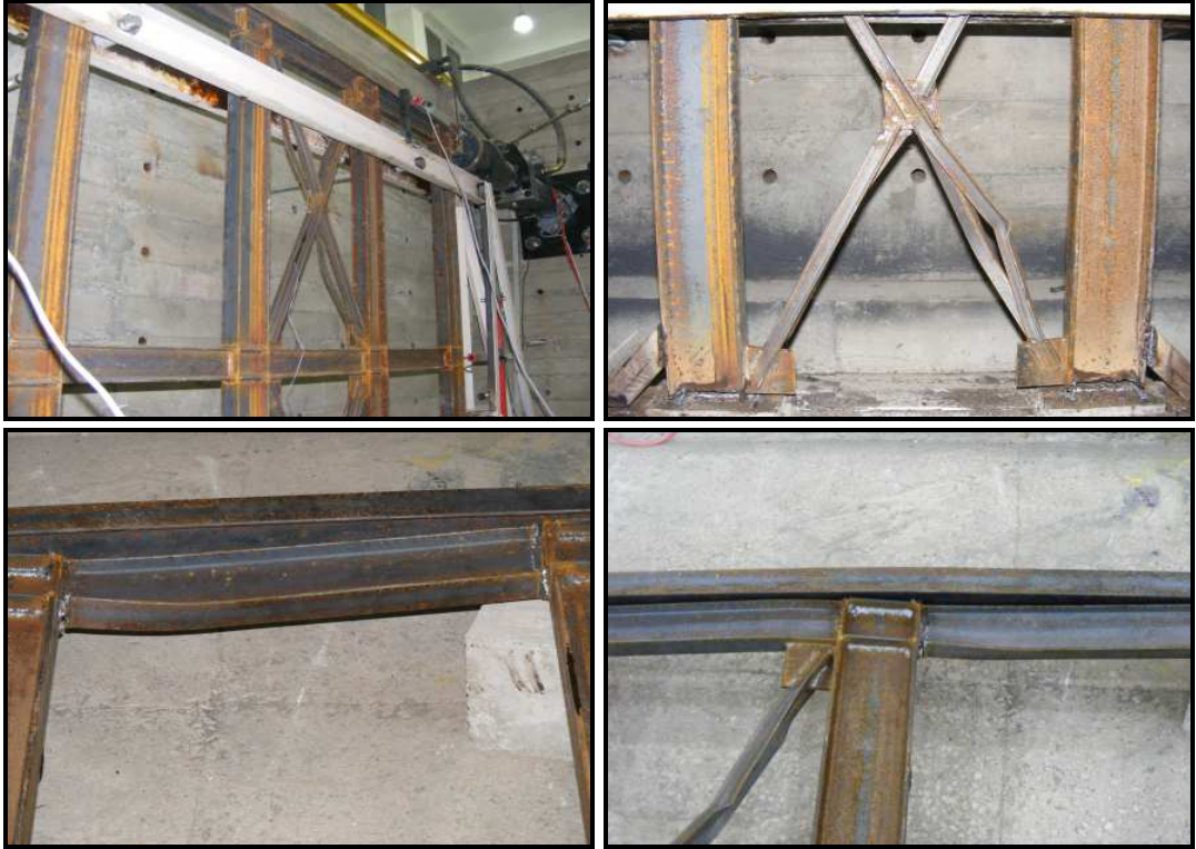
Şekil 120. N-8. Çift yönlü çelik köşegenli çerçeve sistemi için deney sırasında oluşan hasar durumu
