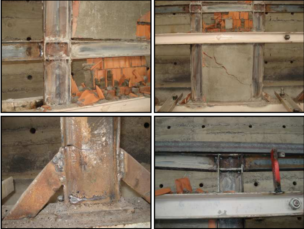
Şekil 85. N-2 Tuğla duvar dolgulu çerçeve sistemi birleşim yerlerinde oluşan hasarlar
