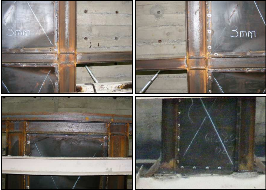
Şekil 108. N-6 Çelik levha perde duvarlı çerçevenin birleşim noktalarında oluşan hasarlar
