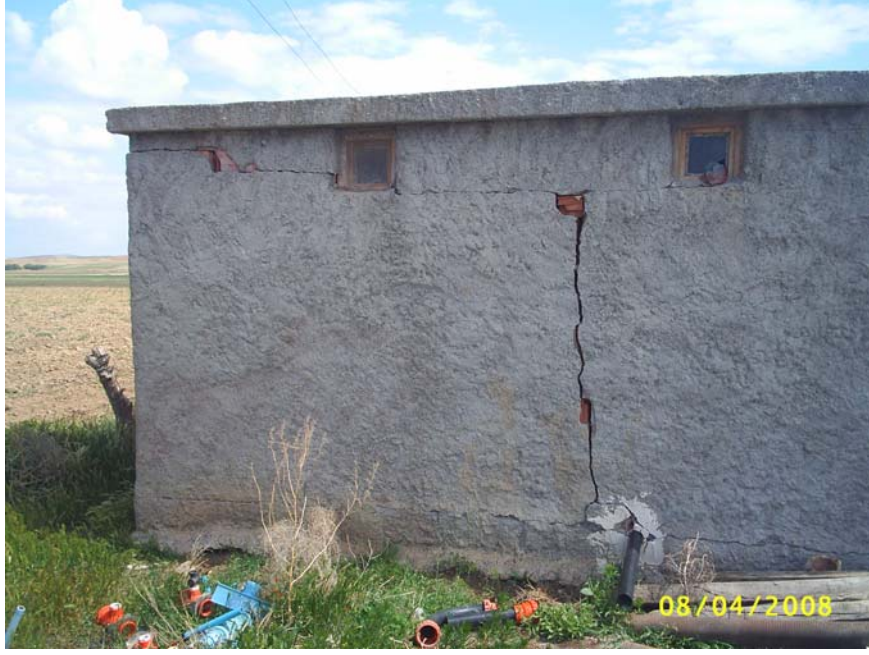
Şekil 2.51. Balâ Depreminde hasar gören yığma bina (Kuzey cephesi)
