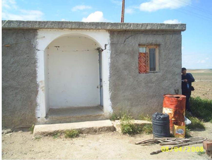
Şekil 2.52. Balâ Depreminde hasar gören yığma bina (Güney cephesi)
