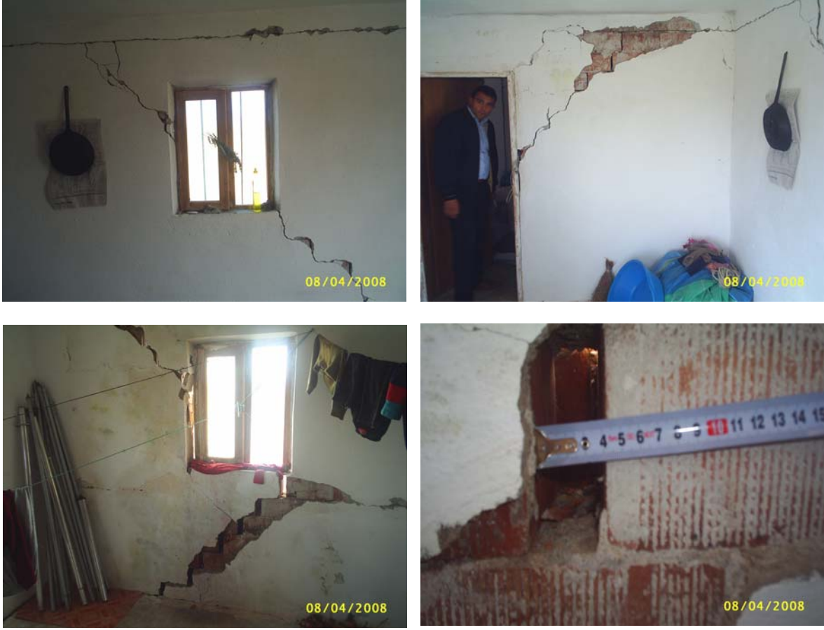
Şekil 2.53. Balâ Depreminde hasar gören yığma bina (taşyıcı duvar çatlakları)
