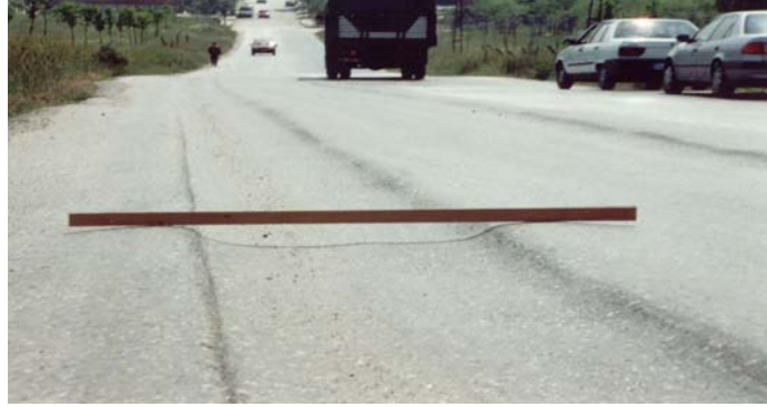
Şekil 21. Tekerlek izinde yapısal oturma örneği
