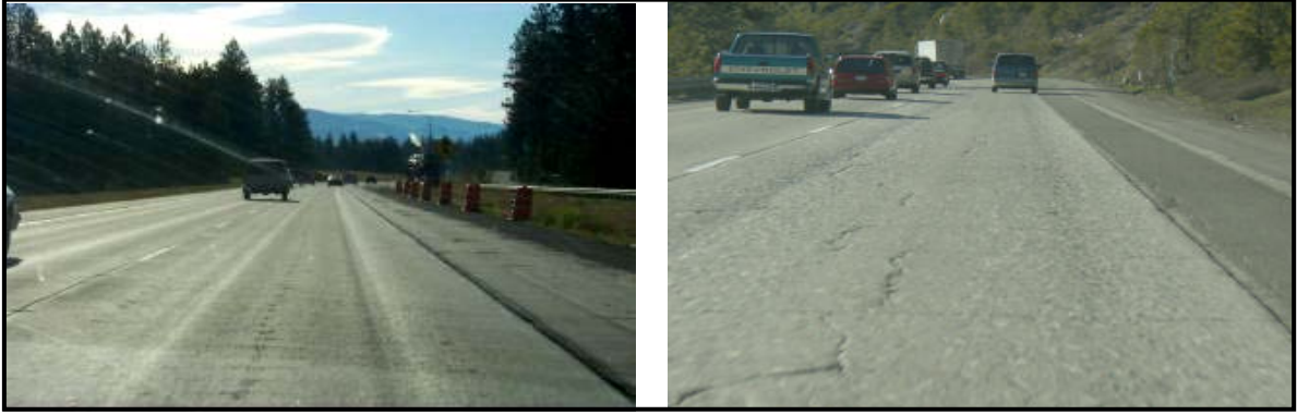
Şekil 23. Çivili lastiklerin yol üzerindeki hasarları
