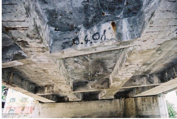
Şekil 9. Farklı etkiler sonucu zarar görmüş köprü tabliyesi (URL-5, 2008).
