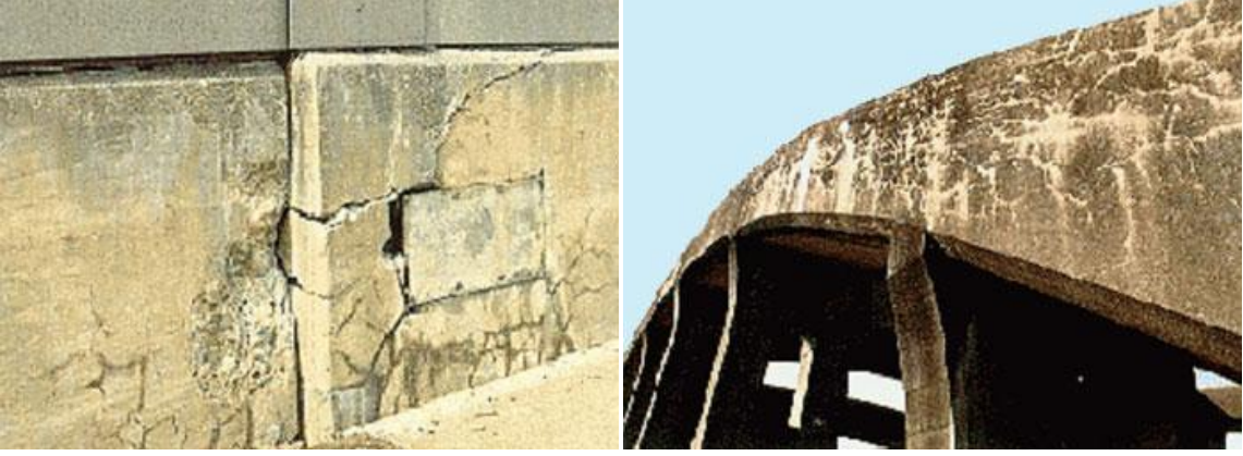
Şekil 4. Betonda alkali-silika reaksiyonu sebebiyle oluşan büyük çatlaklar (URL-1, 2008).
