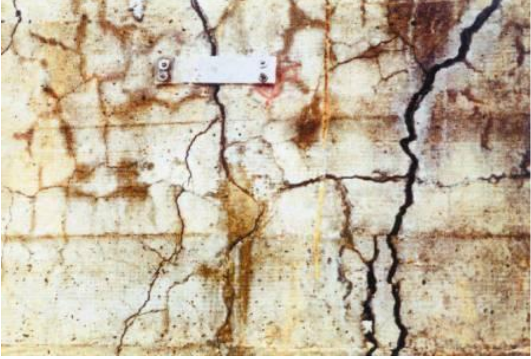
Şekil 6. Betonda alkali-agrega reaksiyonu sonucu oluşmuş derin çatlaklar (URL-3, 2008).
