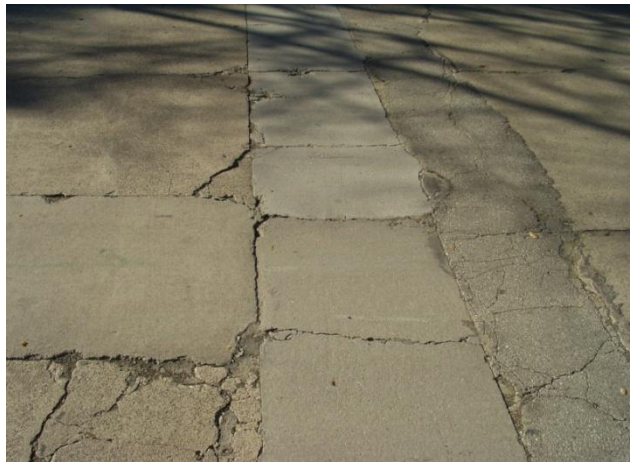
Şekil 10. Aşınma, alkali silika reaksiyonu gibi etkiler sonucu bozulmuş beton yol (URL-6, 2008).
