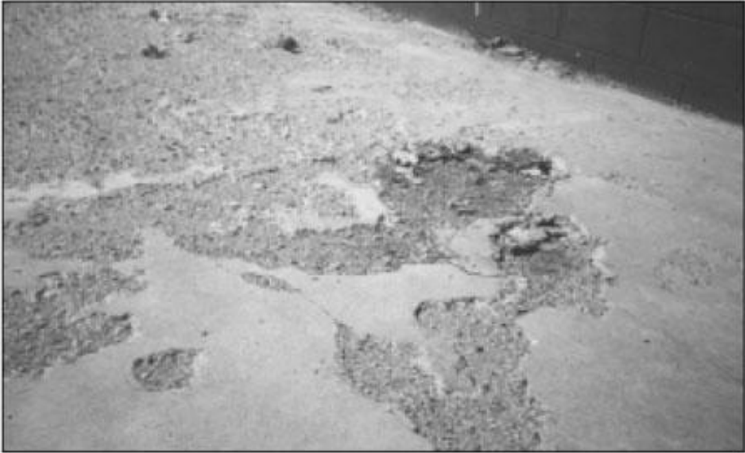
Şekil 7. Beton yolda aşınma ve korozyon etkisi (URL-4, 2008).
