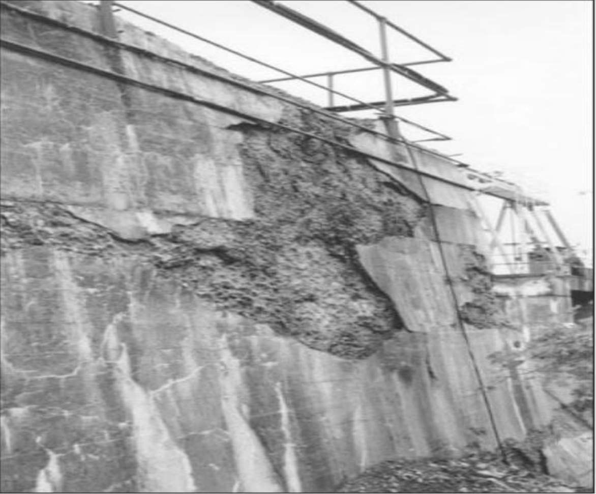
Şekil 5. Betonda donma-çözülme etkisiyle oluşan zararlar (URL-2, 2008).
