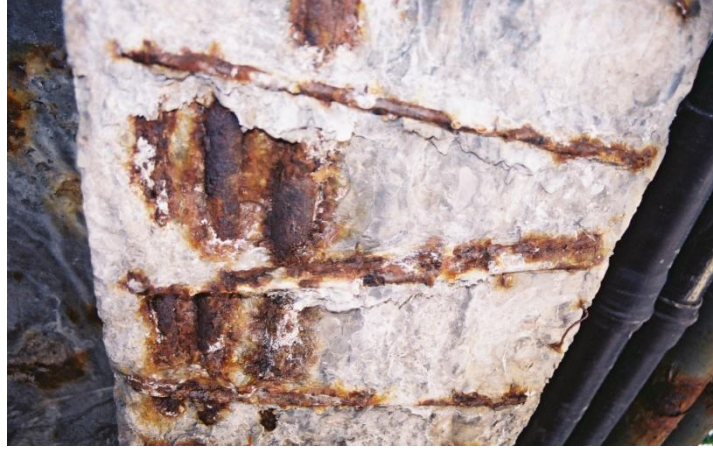
Şekil 8. Donatı korozyonu (URL-5, 2008).
