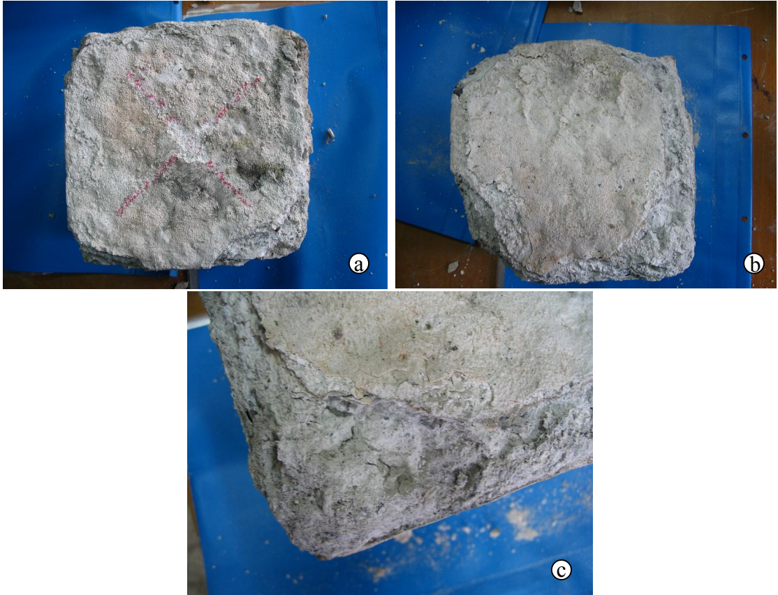
Şekil 15. 20 ay magnezyum sülfat çözeltisinde bekletilmiş mineral katkı içermeyen beton numune görüntüsü. (a) (b) birbirinden farklı iki numunenin görünüşü, (c) beton köşe görüntüsü.
