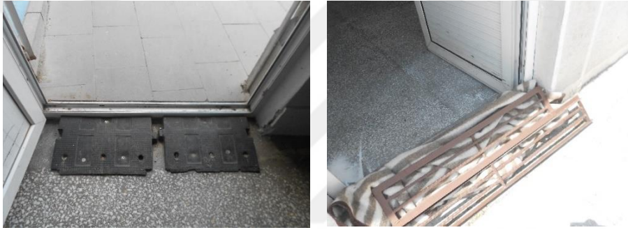
Şekil 126. DÇOEİÖ kapı girişleri
