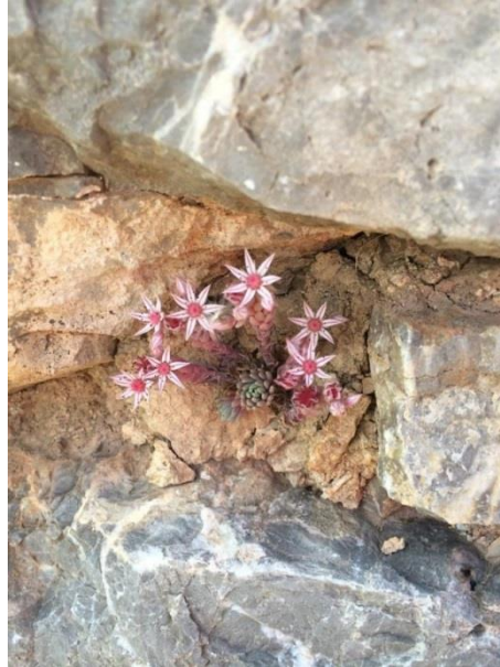
Şekil 20. Duvar yüzeylerindeki derz boşluklarında oluşmuş besin ortamı örneği
