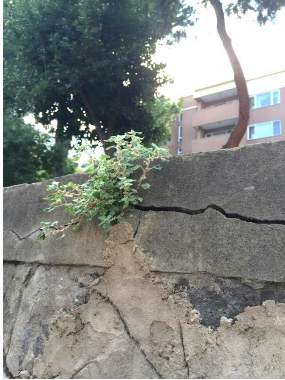
Şekil 35. Duvar üzerindeki beton harpuştada oluşan çatlak ve vejetasyon ( Parietaria judaica )
