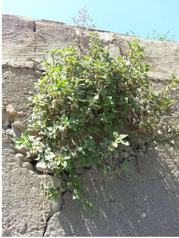
Şekil 34. Beton-Betonarme duvarda çatlakta oluşan vejetasyon ( Parietaria judaica )
