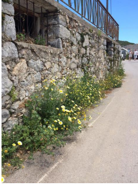
Şekil 50. Duvar önünde iklimik koşulların biriktirdiği sınırlı toprak varlığı ve oluşan vejetasyon
