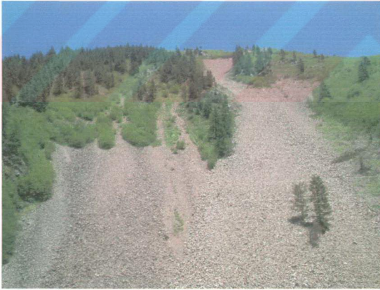
Şekil 30. Pazarcık Yaylası'nda yol yapım çalışması nedeniyle oluşan tahribat
