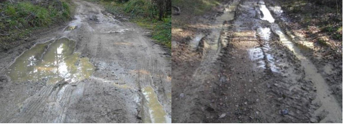
Şekil 24. Üst yapıda meydana gelen bozulmalar
