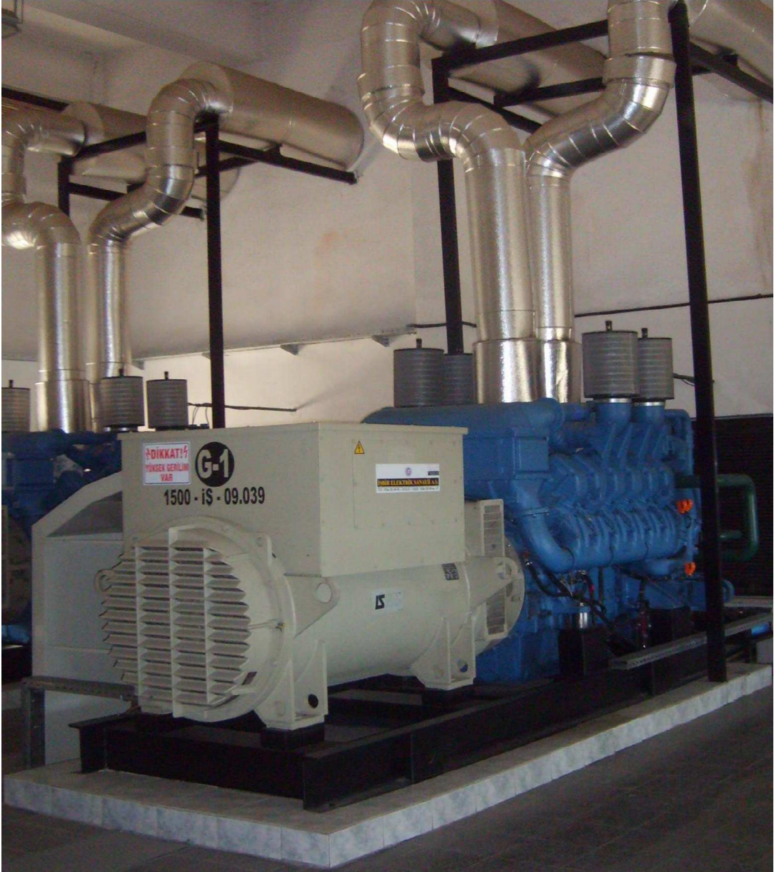
Şekil 2.1. 2x1500 KVA generatör grubu
