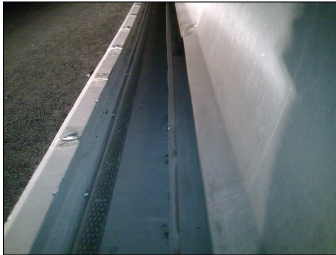
Şekil 2. Tünel yan kablo kanalı
