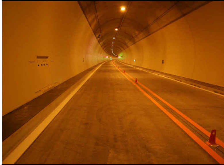
Şekil 4. İç bölge aydınlatması
