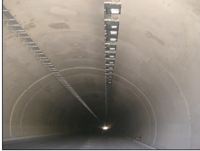
Şekil 1. Tünel kablo tavaları
