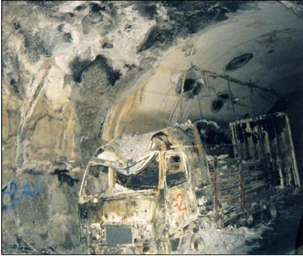
Şekil 17. Mont Blanc yangını sonrası tünelin durumu
