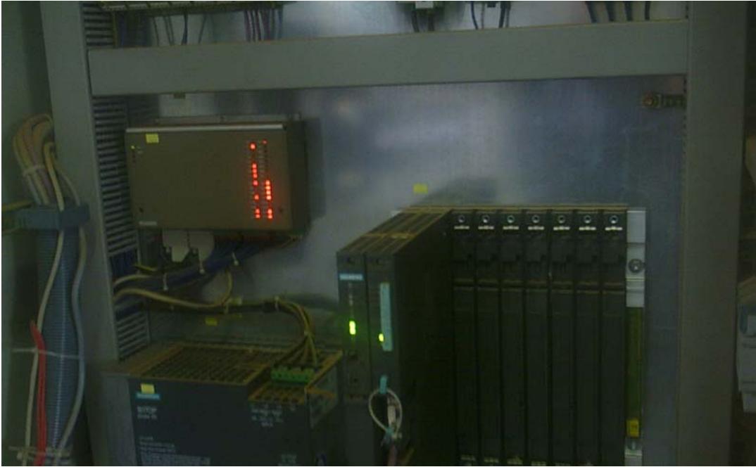
Şekil 75. PLC ile sistemin kontrolü
