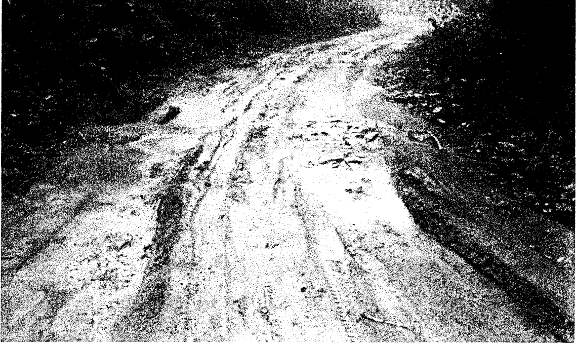
Şekil 44. Drenaj eksikliğinden kaynaklanan yol yüzeyi bozukluğu
