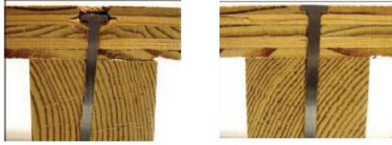
Hatalı Çakılmış Bağlantı Elemanı
