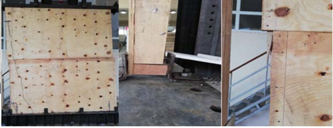
Şekil 38. 7. Duvarda oluşan hasar görünümleri
