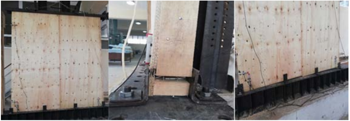
Şekil 33. 9. Duvarda oluşan hasar görünümleri
