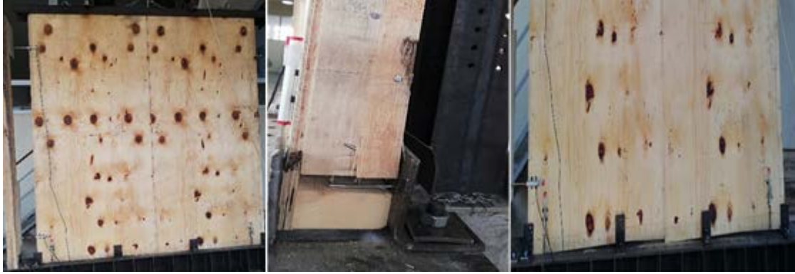
Şekil 29. 2. Duvarda oluşan hasar görünümleri
