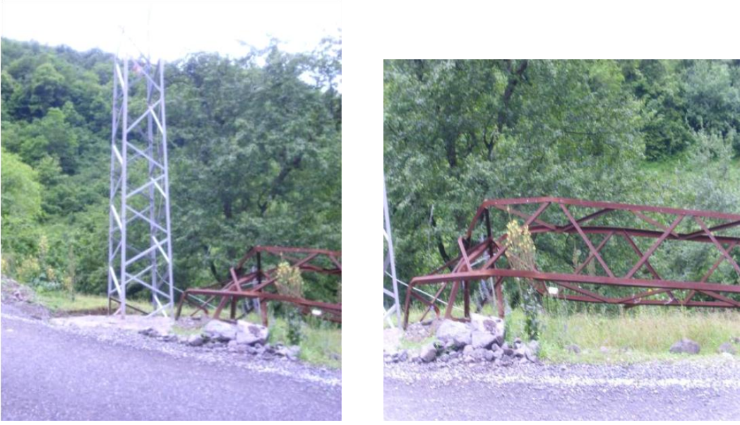
Şekil 3. Borçka ilçesinde bulunan dış hava koşullarından ve korozyondan etkilenen bir demir tel direği (sağda) ve yeni hizmete sunulmuş bir demir tel direğinin karşılaştırılması (solda)
