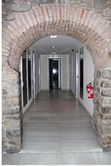
Şekil 41. Malzeme kullanımında dizimi etkileyen palempsest, mermer zemin- taş duvar- alçı levha duvar ve tavanlar (Faiz Büyükçam, 2018)
