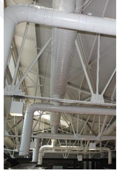
Havalandırma ve ısıtma sistemi
