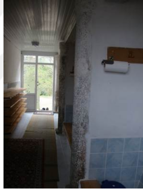
Şekil 64. Dolanlı Köyü Camisinin son cemaat yerinde duvarlar içinde kalan taş sütunlar. (VGM arşivinden)
