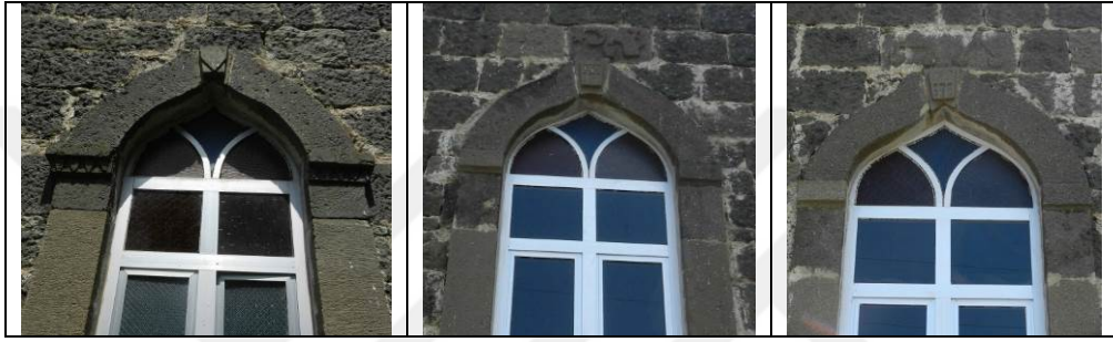
Şekil 139. Açıkan Köyü Eski Camisinin pencereleri kilit ve duvar üzerindeki taşçı işaretleri
