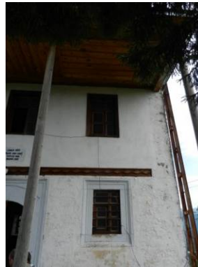
řekil 109. amlık Ky Yukarı Mahalle Camisinin tař yıđma ve ahřap karkaslı giriř cephesi
