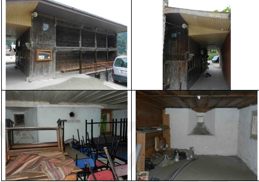
Şekil 425. Uzungöl Filak Mahallesi Camisi'nin açık ve kapalı son cemaat yerleri (üstte). Bodrum katta yer alan odalar (altta)
