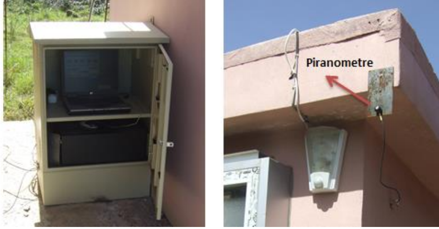
Şekil 28. Dış ortama yerleştirilen kayıt sistemi ve duvar yüzeyindeki silikon piranometre
