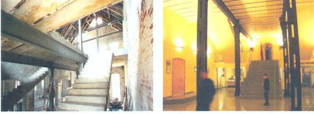
Şekil 116. İspirtohane'nin önceki restorasyonunda özgün volta döşemenin bir kısmının boşaltılmasıyla birbirine bağlayan büyük betonarme merdivenin restorasyon öncesindeki [155] (solda) ve sonrasındaki görünümü (sağda) [156].
