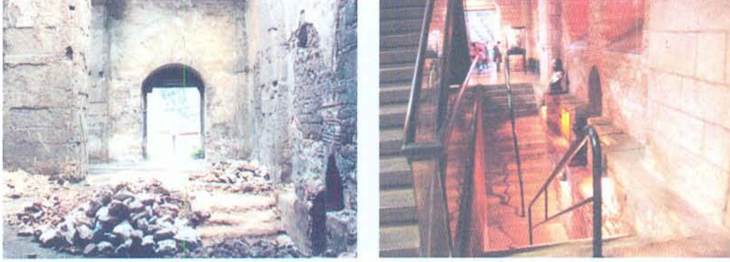
Şekil 127. Lengerhane'nin bodrum kattaki geçitinin zemin kata bağlantısını sağlayan merdivenlerin restorasyon öncesi (solda) [155] ve sonrası (sağda) [269] görüntüleri
