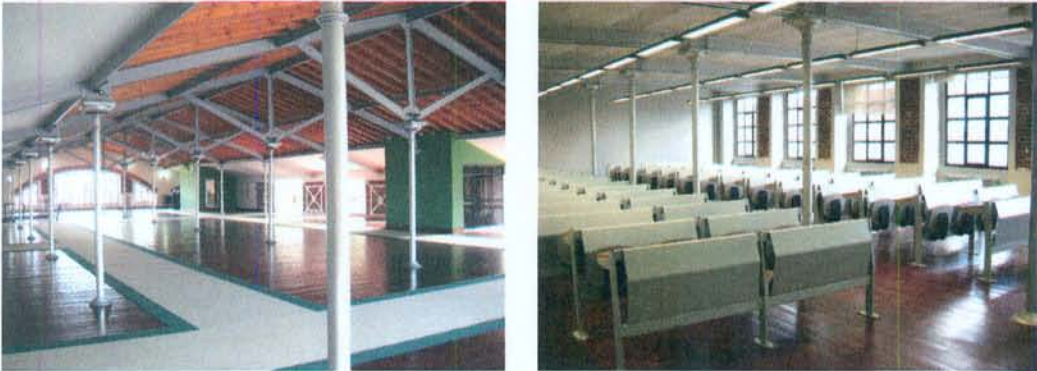
Şekil 101. Cıbalı Tütün ve Sigara Fabrikası'nın yeniden kullanımında, kolon, kiriş, ahşap döşeme kaplaması, volta döşeme ve çatı makası gibi mimari strüktür ve elemanlarının bakım yapılarak korunduğu mekânlarından görülen fotoğraflar [231].
