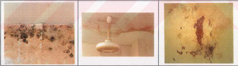
Şekil 3. Nemin yol açtığı yapısal sorunlar [24].
