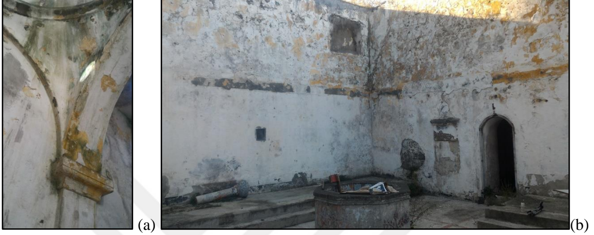
Şekil 61. (a) Kubbe altı silmelerinde yer alan aşınma, (b) Soğukluk mekânında yer alan aşınma ve derz kaybı
