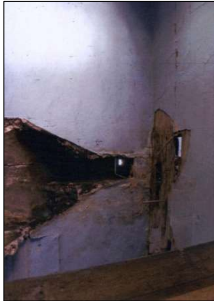
Şekil 56. Kodlama Eğitim Merkezi zarar görmüş duvarları (KVKBK, 2020).
