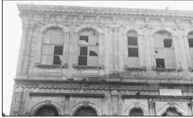
Şekil 44. Hacıkadızade Konağı'nın cephedeki kırılmış pencereler (Sümerkan, 2020).
