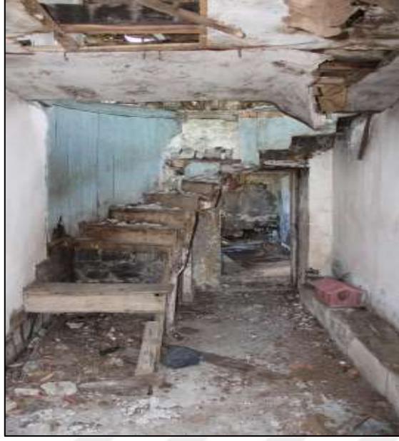
Şekil 37. Bekir Turan Evi'nin yıkık merdiveni ve deforme olmuş tavan kaplamaları (Ataman, 2020).
