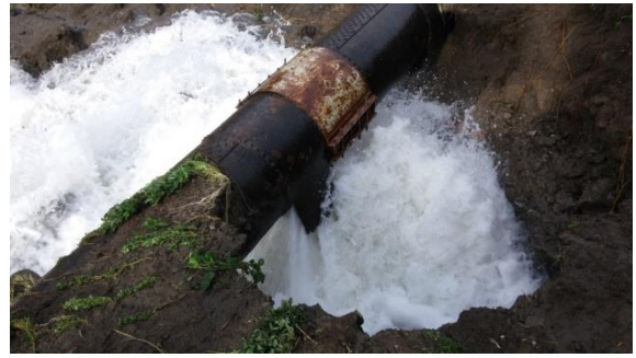
Visera Santrali'ne su getiren cebri borularda oluşan hasar
