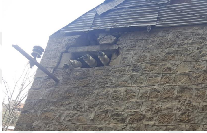
Şekil 58. Visera Santrali'nin kuzeybatı duvarındaki hasar
