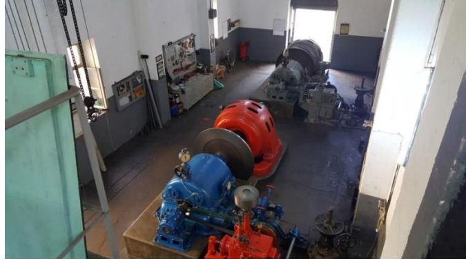
Şekil 28. Visera Santrali'nin türbin alanı
