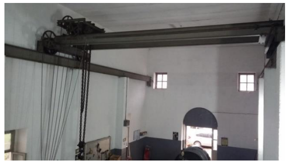
Türbin alanının tavanındaki vinç
