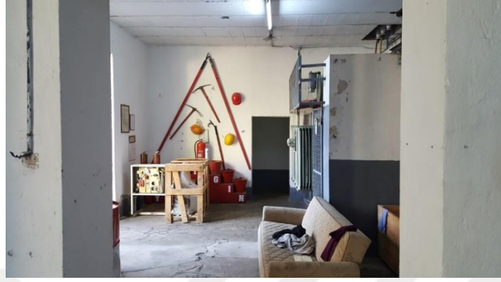
Şekil 33. Visera Santrali'nin trafo odası
