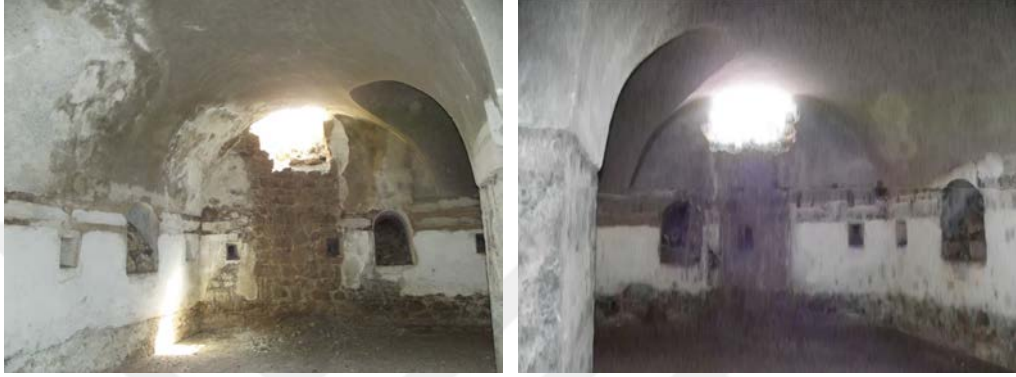
Şekil 101. Mecidiye Tabyası'nın yıkılan kısımları
