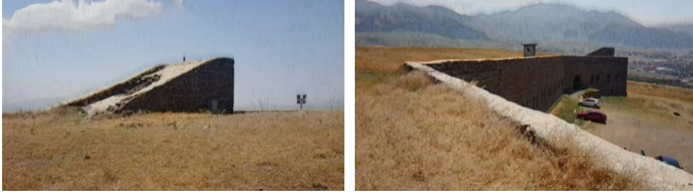
Şekil 120. Mecidiye tabyası cephesinde çimento esaslı sıva uygulamaları
