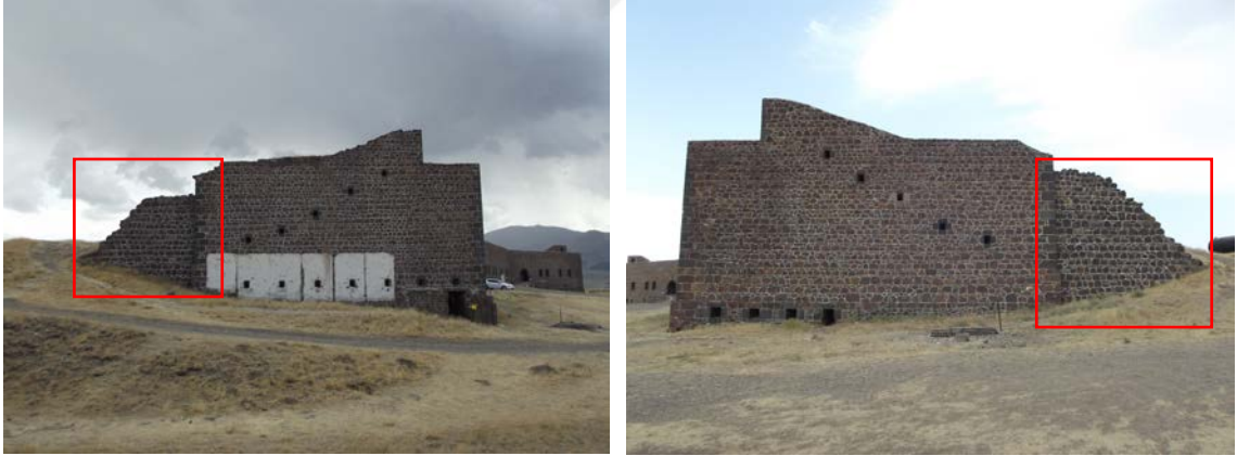
Şekil 108. Mecidiye Tabyası'nın kuzey ve güney cephelerinde bulunan ve sonradan eklendiği düşünülen duvar
