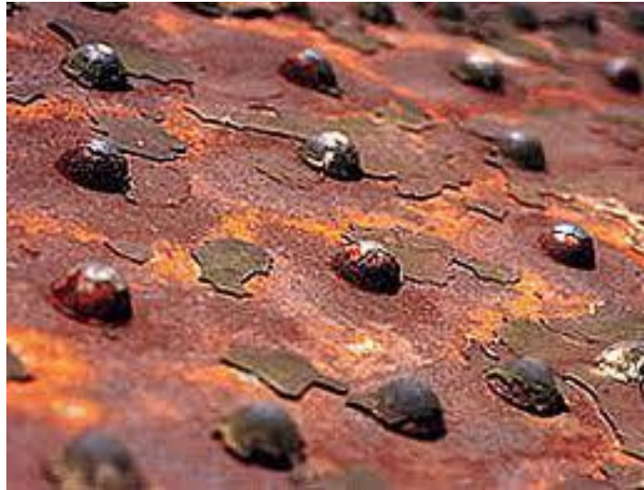
Şekil 8. Metal elemanda korozyon (URL-3).
