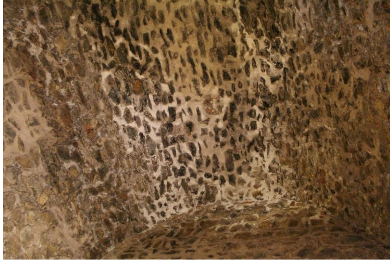
Şekil 12. Tokat Çukur Medrese, taş yüzeyde tuzlanma
