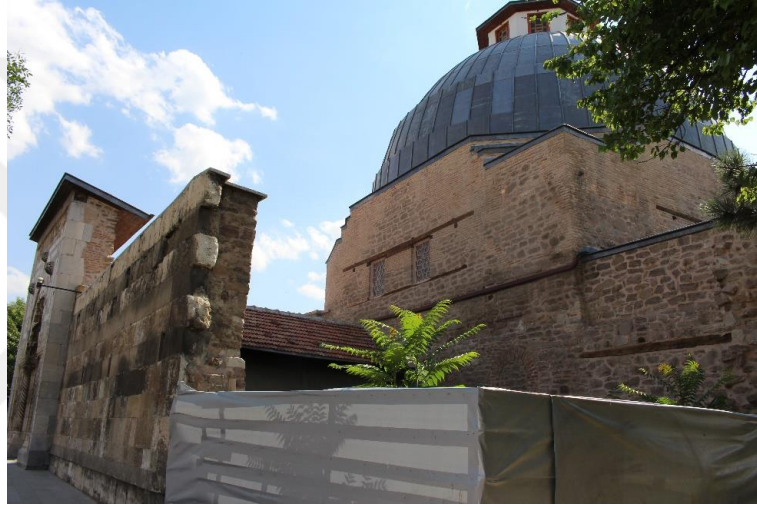
Şekil 1. Konya Karatay Medresesi, yıkılan hücreler
