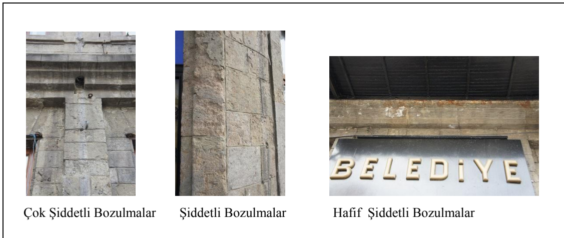
Şekil 8. Belediye binası bozulmaları
