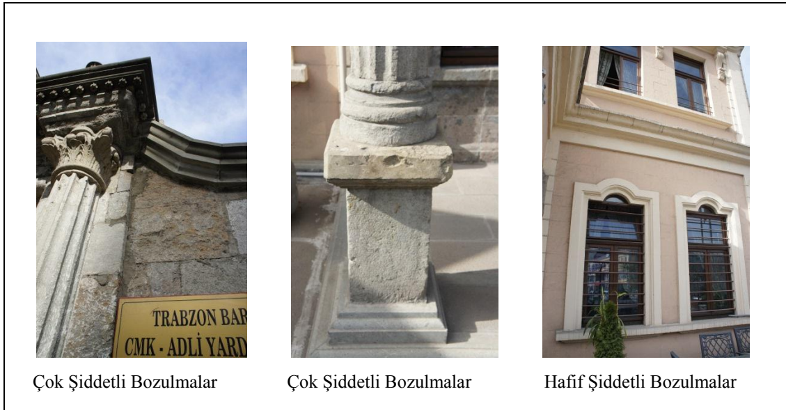
Şekil 6. Baro binası bozulmaları
