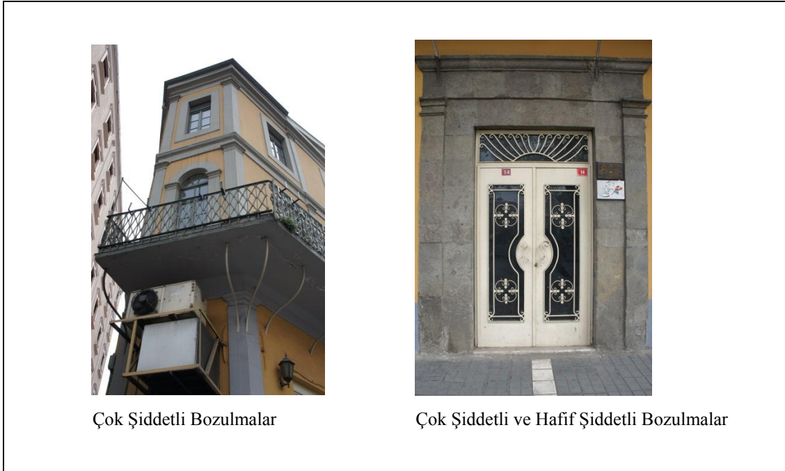
Şekil 9. Belediye Arge Binası bozulması
