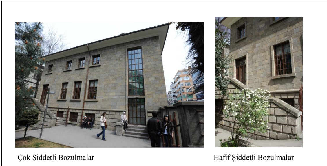
Şekil 24. Ziraat Bankası binası bozulmaları
