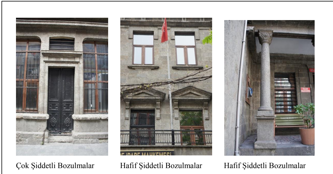
Şekil 15. İdari Mahkeme binası bozulmaları
