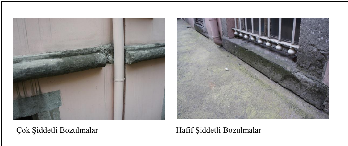
Şekil 21. Sanat Evi binası bozulmaları
