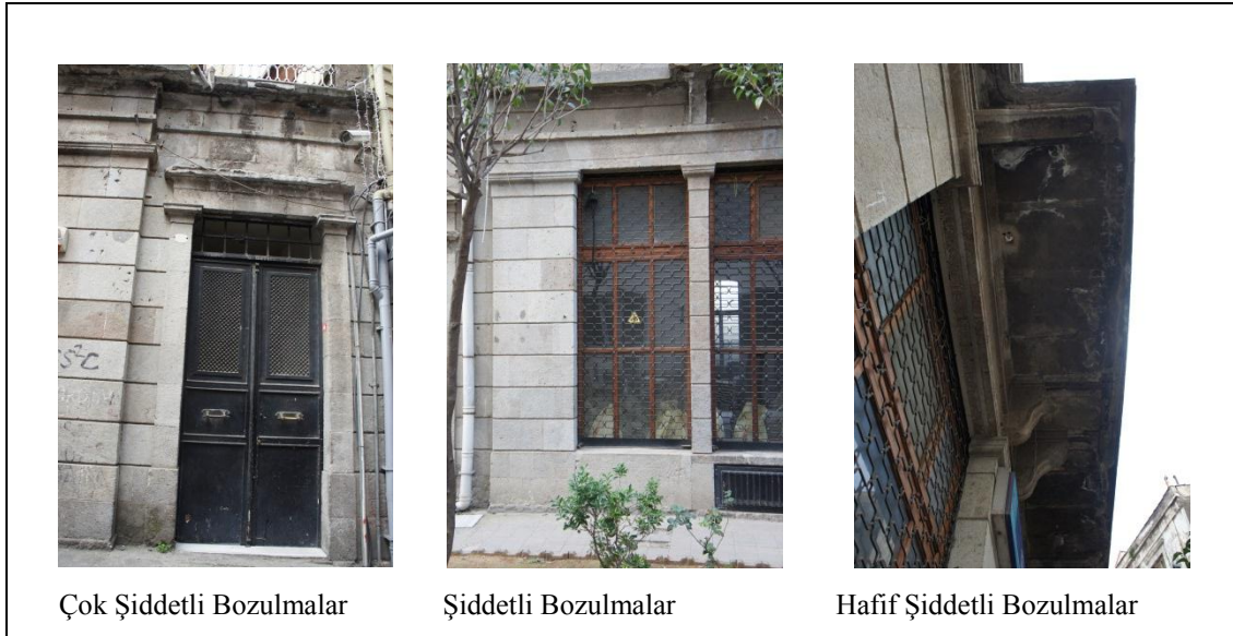
Şekil 20. PTT Baş Müdürlük Binası bozulmaları
