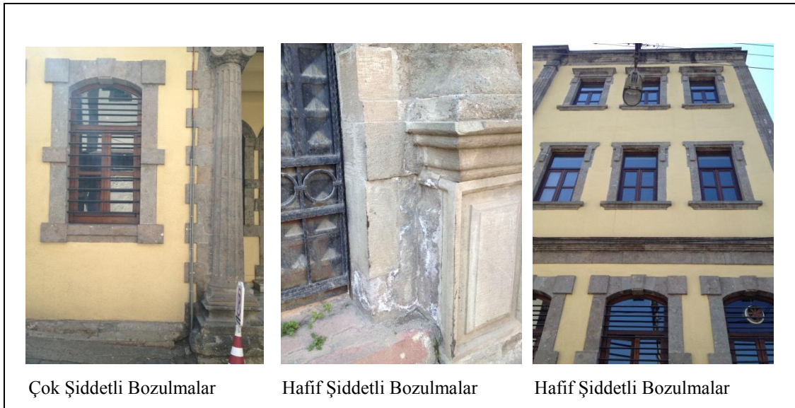
Şekil 22. Tiyatro Müdürlüğü binası bozulmaları
