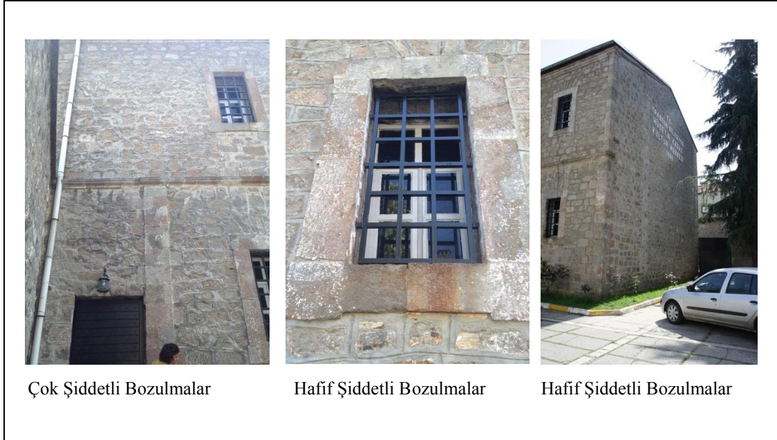
Şekil 14. Hüseyin Kazaz Kültür Merkezi binası bozulmaları
