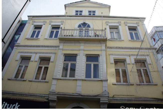
řekil 18. Mahmut Golođlu Kltr Merkezi binası bozulmaları
