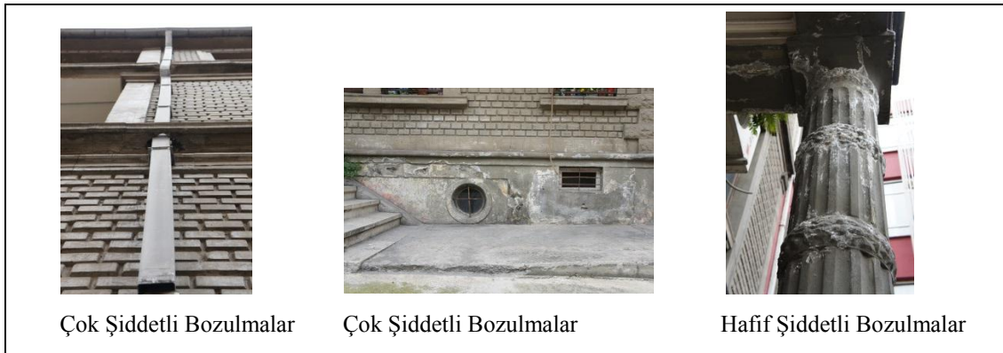
Şekil 5. Ana Çocuk Sağlığı Aile Planlama Merkezi Baş Tabipliği binası bozulmaları
