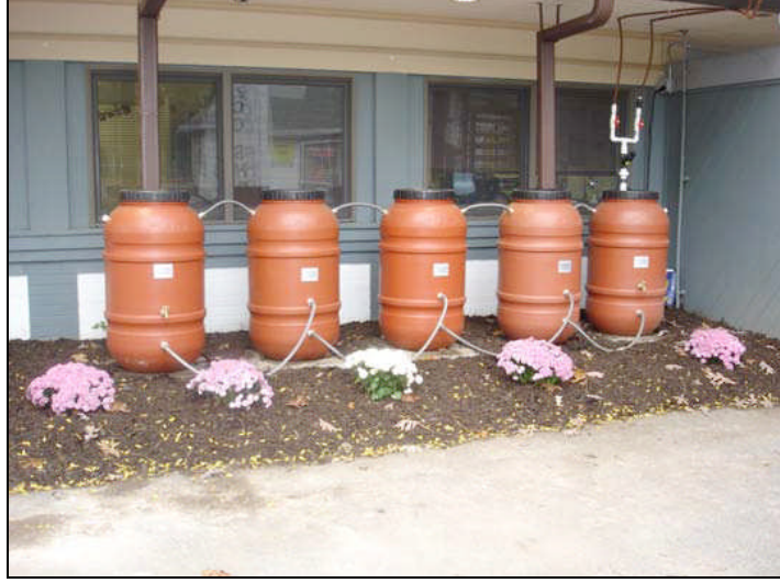
Şekil 65. Basit yağmur suyu toplama tankları (58)
