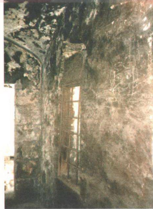
Şekil 78. Alacahan'da çatlamış ve hasar görmüş duvarlar
